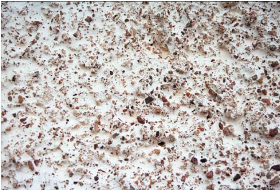
Fig 6. Yttersta lagrets spritputs (period 5) med synlig ballast. Detta putslager hade dålig vidhäftning och knackades ner på hela Landtornets fasad. Bildnr: lp20070163
