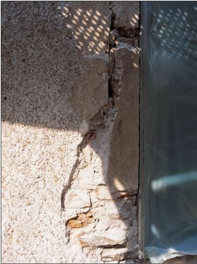
Fig 28. Fönster i Sjötoronet med i sidled ändrad fönsteröppning murad med tegel. Bildnr: ld20020137.
