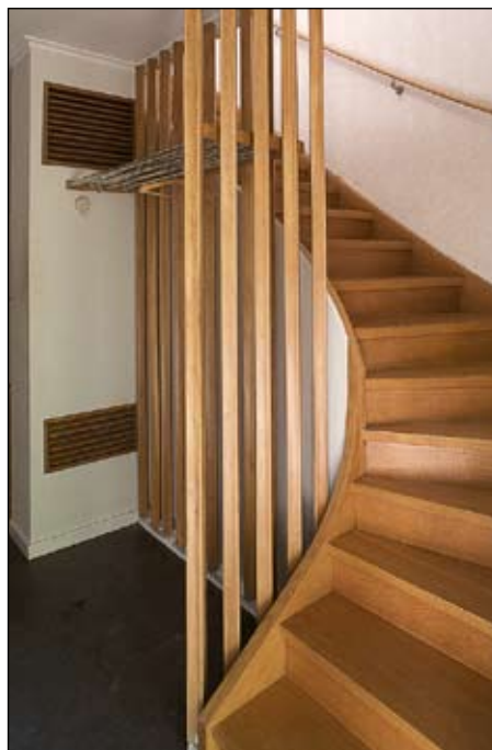
Fig 6:5. Returluftstrumma med frånluftsdon, Tulkavägen 74 rum 101. Längs golvet löper slitsade golvlister som släpper ut uppvärmd luft. Bildnr ldng20070571.
