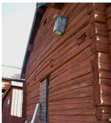
Väggen kalvar ut.
