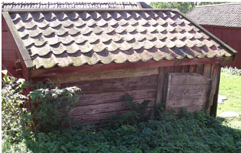
Svinhuset har mycket sly runt sig och en för hög marknivå.
