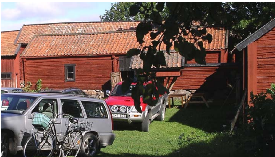
På ladugårdens norra takfall regnar det in.
