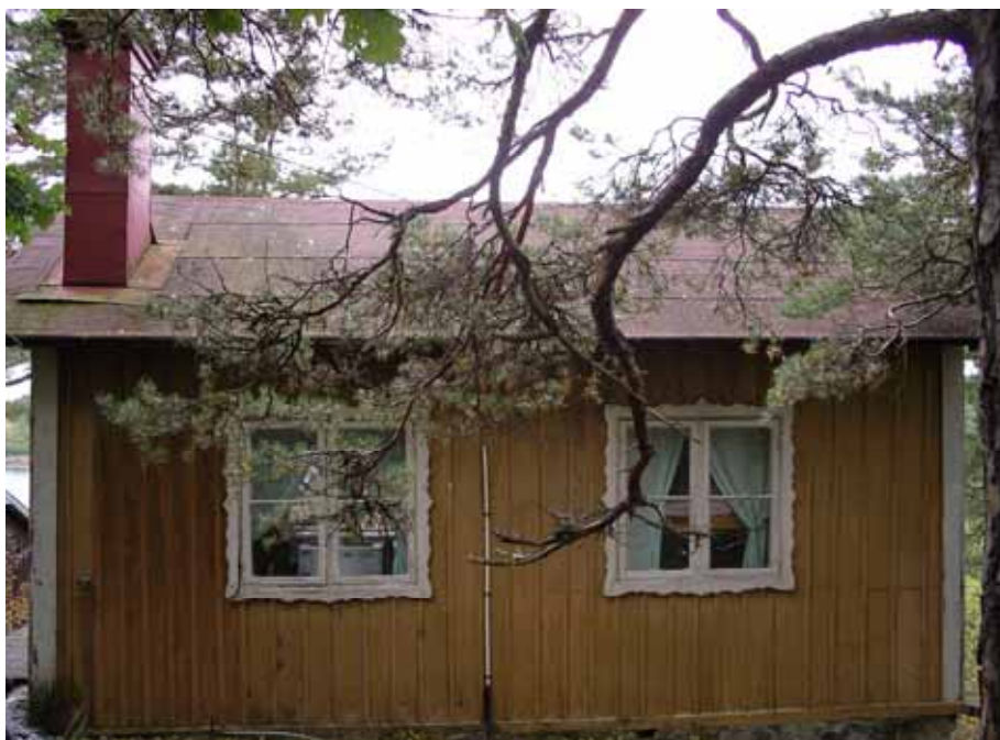
Ill. 14. I det vänstra hörnet mellan fönstret och knuten sitter en modernare locklistpanel, samma bredd som murstocken på insidan. Notera den skarvade panelen på 90 cm höjd.
