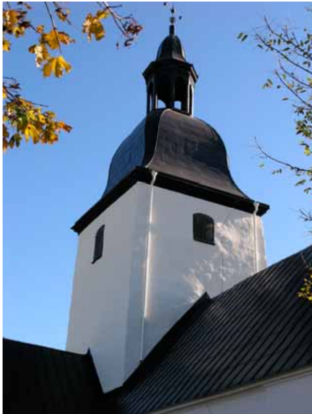
Tornet från nordväst efter åtgärd. Nymålat torntak med ny fotränna och nya stuprör. Foto Cecilia Pantzar 2007. Bildbeteckning lp20070155.
