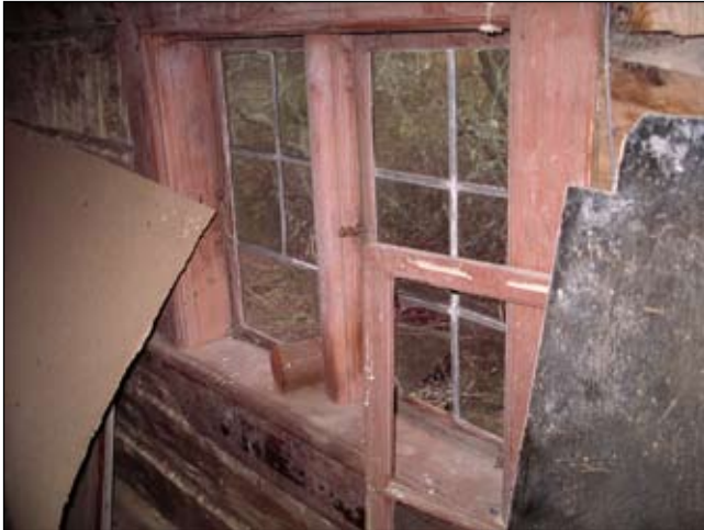
Fig. 27. Fönstret i hallen med blyspröjs. Bildnr Lp 20080730.
