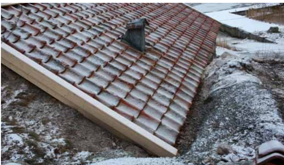
Jordkällaren efter renoveringen med utgrävd takfot samt dräneringskanal. Foto Lotta von Liewen Wistrand, Stockholms läns museum, 2008
