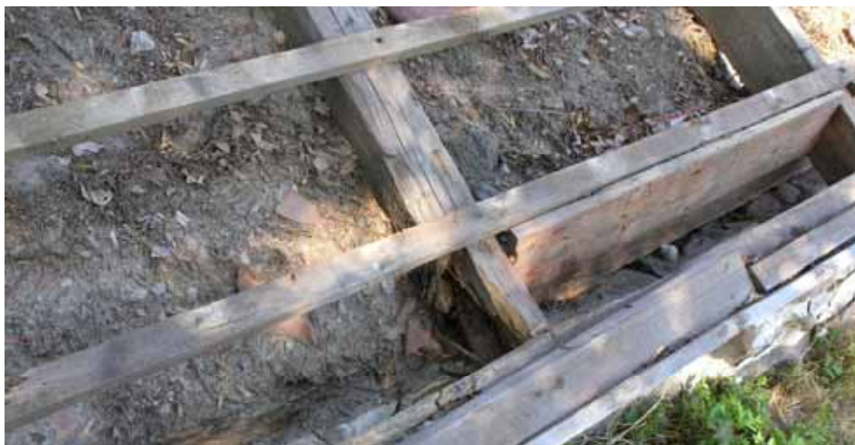
Några av högbenen och delar av takfoten låg direkt på marken, vilket orsakat både röt- och hussvampangrepp i dessa partier. För att motverka vidare spridning grävdes jordmassorna ur. Foto Andreas Lindblad, Stockholm läns museum, 2008
