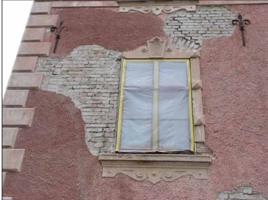
Skadade fönsteromfattningar i östra fasaden. Foto: Lisa Sundström, 2007. Bild nr: lp20080018
