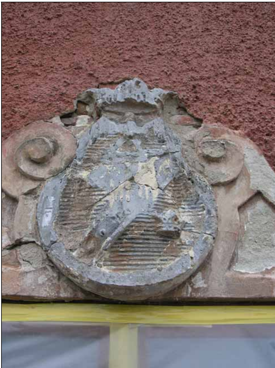
Befintligt vapen av gips i den östra fasaden var så skadat varför beslut togs att tillverka ett nytt. Foto: Lisa Sundström, 2007. Bild nr: lp20080020
