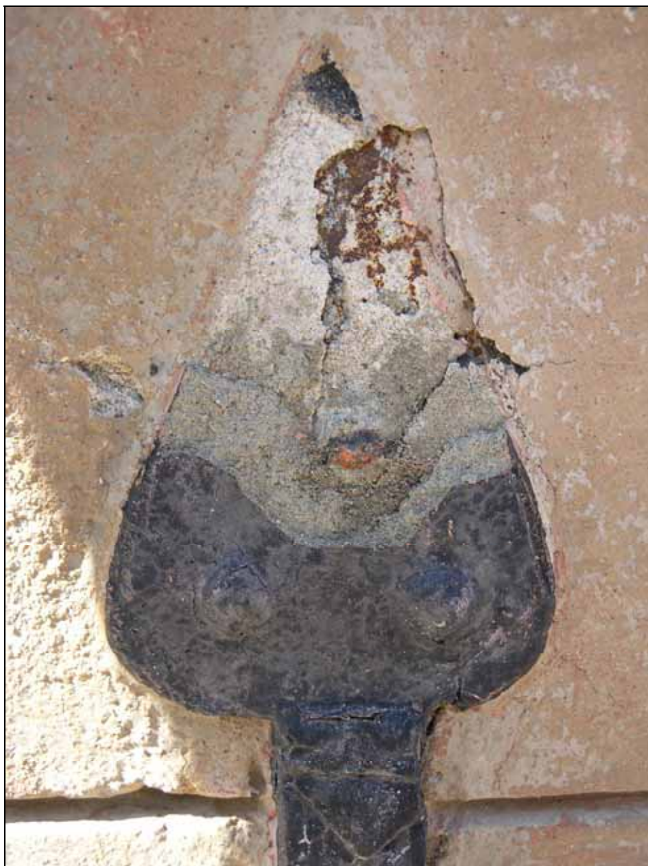
Delar av ankarjärnen har tidigare lagats med puts som släppt. Järnen lagades upp och målades. Foto: Lisa Sundström, 2007. Bild nr: lp20080016
