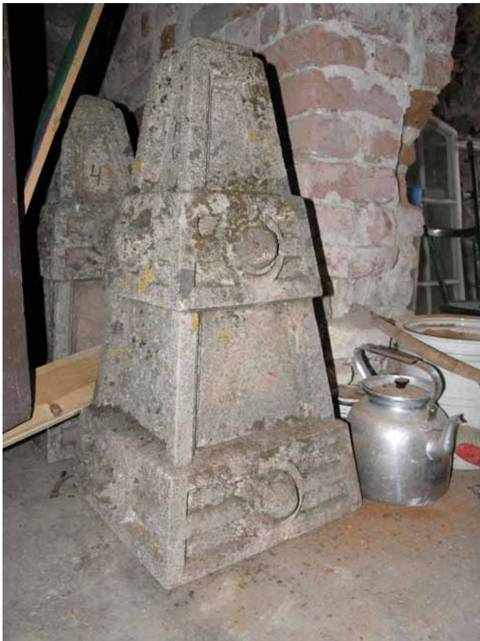
Obelisker av betong från 1891 års restaurering togs ned då de var skadade. Foto: Lisa Sundström, 2007. Bild nr: lp20080022
