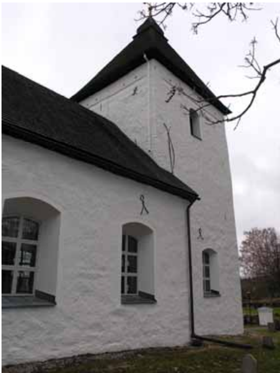
Th. Tornet från nordöst. Lägg märke till den nya avvattningen på tornets östfasad. Bildbeteckning lp2008008. Foto Cecilia Pantzar 2007.
