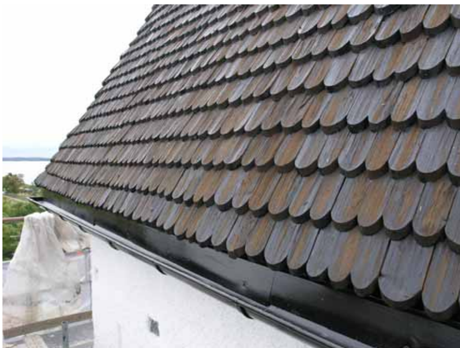
Hängränna på tornet, tillkommen som en följd av oönskade tjärrinningar från spåntaken i samband med att dessa tjärades. Bildbeteckning lp20080074. Foto Cecilia Pantzar 2007.
