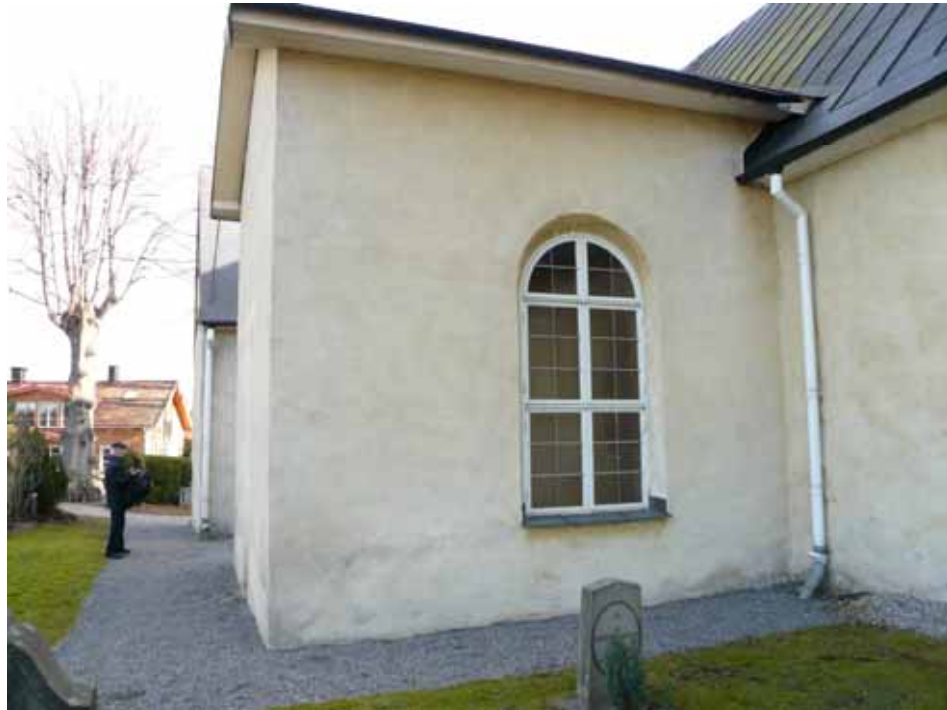
Södra korsarmen före renovering med vita fönster och stuprör. Bildbeteckning lp20080090. Foto Jean-Paul Darphin 2007.
