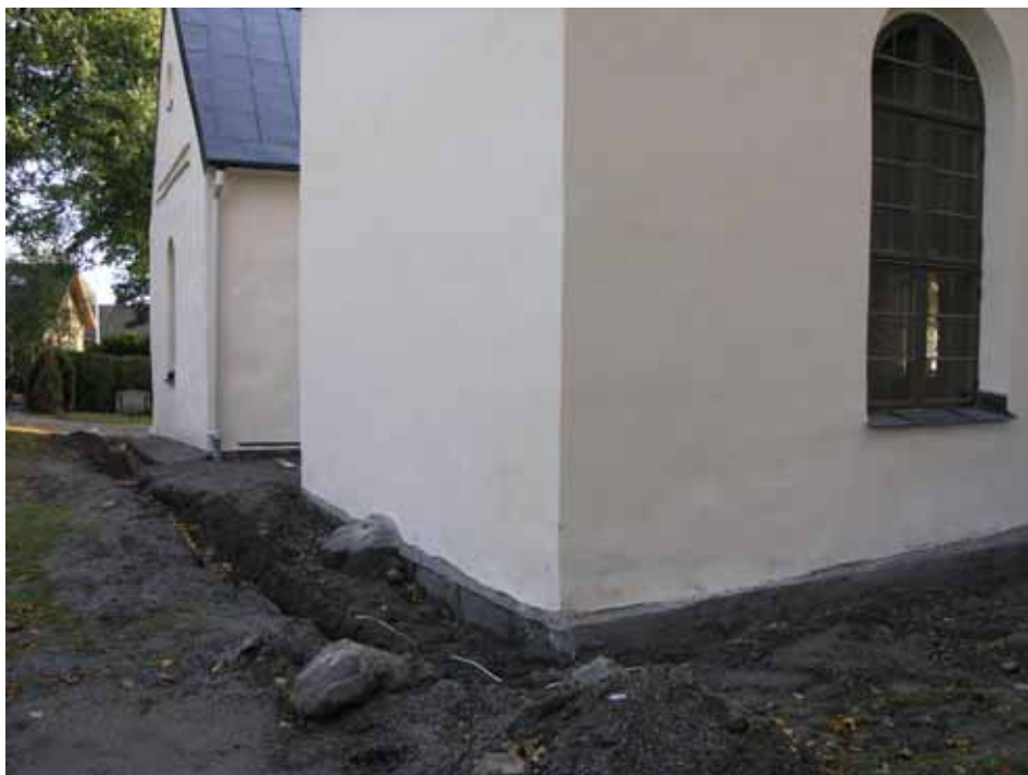
Grävning för dränering utmed kyrkans norra sida. Närmast syns norra korsarmen. Schaktet uppmätte endast ett djup på omkring 30 cm. Bildbeteckning lp20080098. Foto Cecilia Pantzar 2007.
