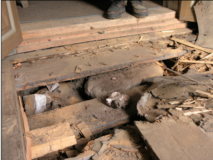
Under det befintliga golvet låg till hälften ett bredare brädgolv. Foto: Lisa Sundström. Bildnr: lp20090161.
