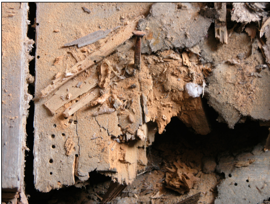
Det bredare brädgolvet var kraftigt skadat. Foto: Lisa Sundström. Bildnr: lp20090162.
