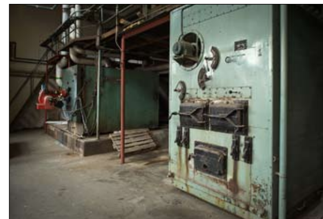
Värmepannor i panncentral. Ldng20090296
