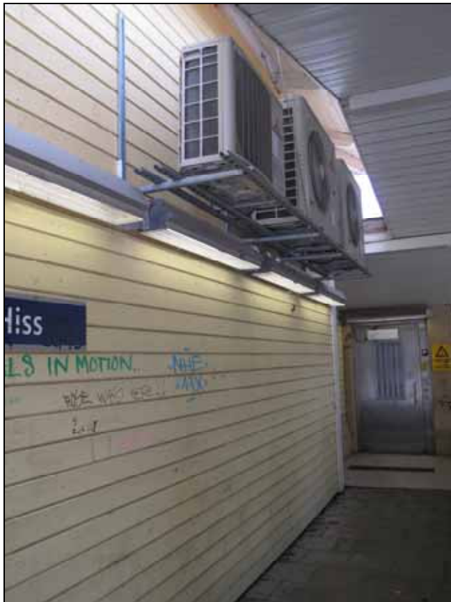
Fläktar installerade på stationshusets fasad mot norr. Bildnr: lp20090396, Stockholms läns museum
