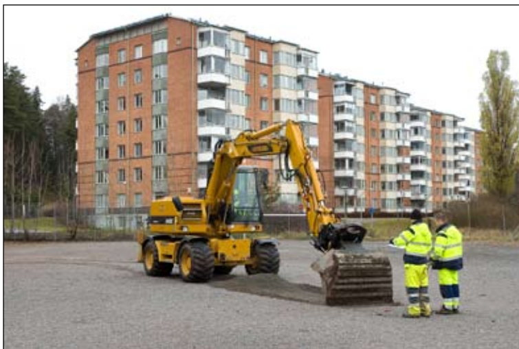
Fig 3. Grävmaskinen grävde i tunna skikt. Här kontrolleras fotbollsplanen. Foto Leif Grönwall, SSLM bild nr LP 20080894.
