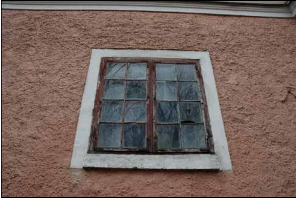
Traktorgaraget. Äldre karmar och fönsterbågar. Foto: Ulrika Sahlsten. Lp20090422.
