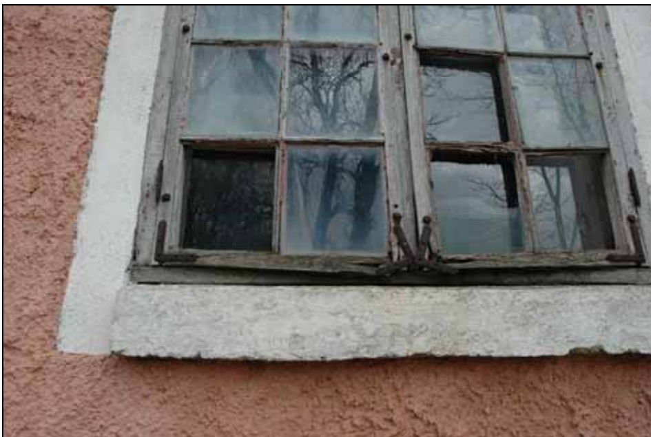
Traktorgaraget. Äldre karmar och fönsterbågar. Foto: Ulrika Sahlsten. Lp20090423.
