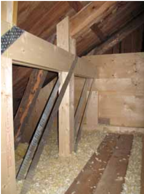
Vertikalt fackverk av trä med diagonala vinddragband av rostfritt stål upphängt på kyrkans gavlar. Bildbeteckning lp20090527 Foto Gunilla Nilsson 2009
