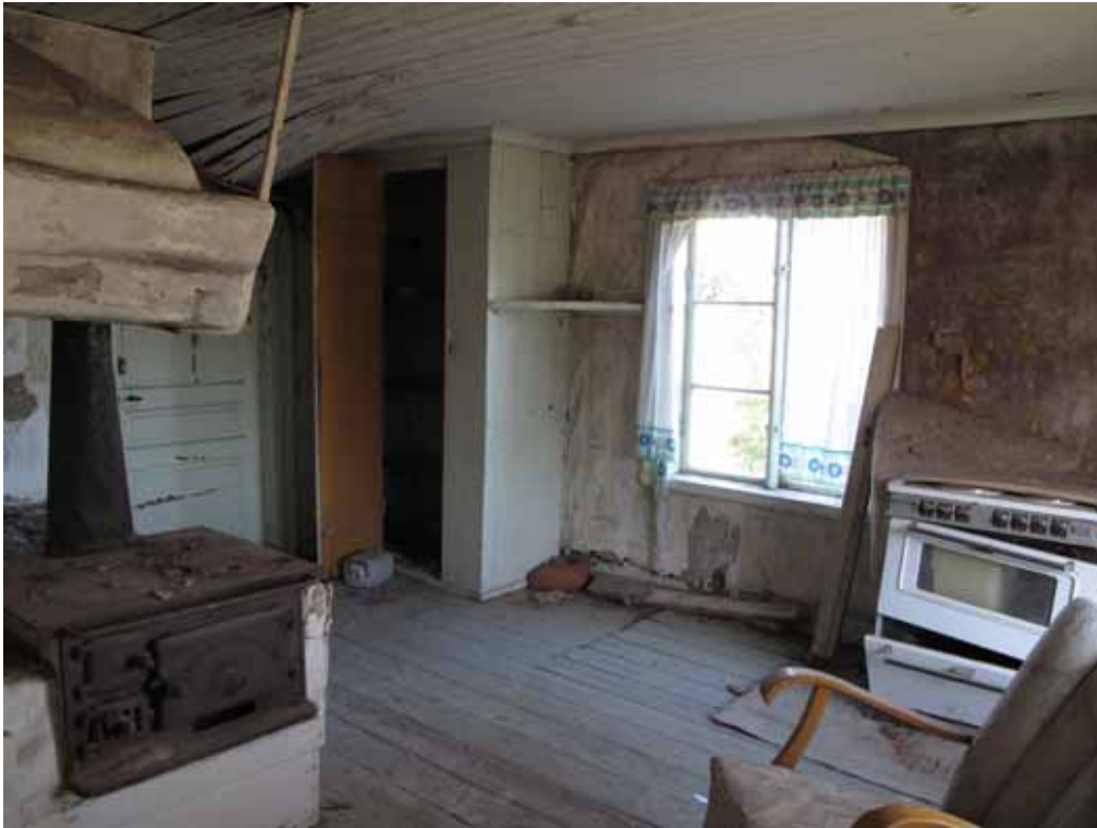
Rum 3 – köket. Innertaket av pärlspånt rasar in i västra delen mot hallen. Tapeterna faller ner och reveteringen blottas. Bildnr lp20090518. Foto Cecilia Pantzar.
