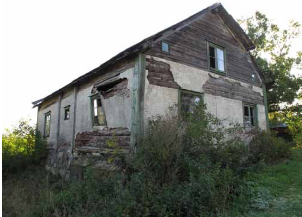
Norra fasaden har en långt gången skada i den västra delen. Väggen kalvar och drar med sig både vindsbjälklag och fönster. Bildnr lp20090504. Foto Cecilia Pantzar.
