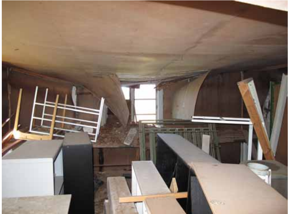
Rum 4. Taket och mellanbjälklaget är på väg att rasa in i den norra delen. Skadan är kopplad till den kalvande nordfasaden. Bjälklaget bör stämpas för att undvika total kollaps. Utrymmet har fungerat som garage på senare tid. Bildnr lp20090520. Foto Cecilia Pantzar.
