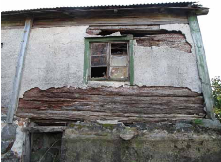
Närbild på den skadade delen av nordfasaden. I sockeln syns ingången till källaren. Mellan ingång och västgavel löper en påmurad betongklack. Vid en reparation krävs byte av timmer i stora delar av detta väggparti. Bildnr lp20090508. Foto Cecilia Pantzar.
