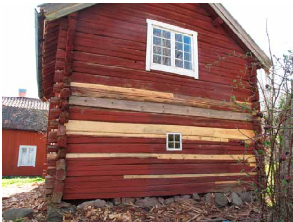
Västfasaden efter lagning. Inga lagningar är genomgående. Lp20110372.
