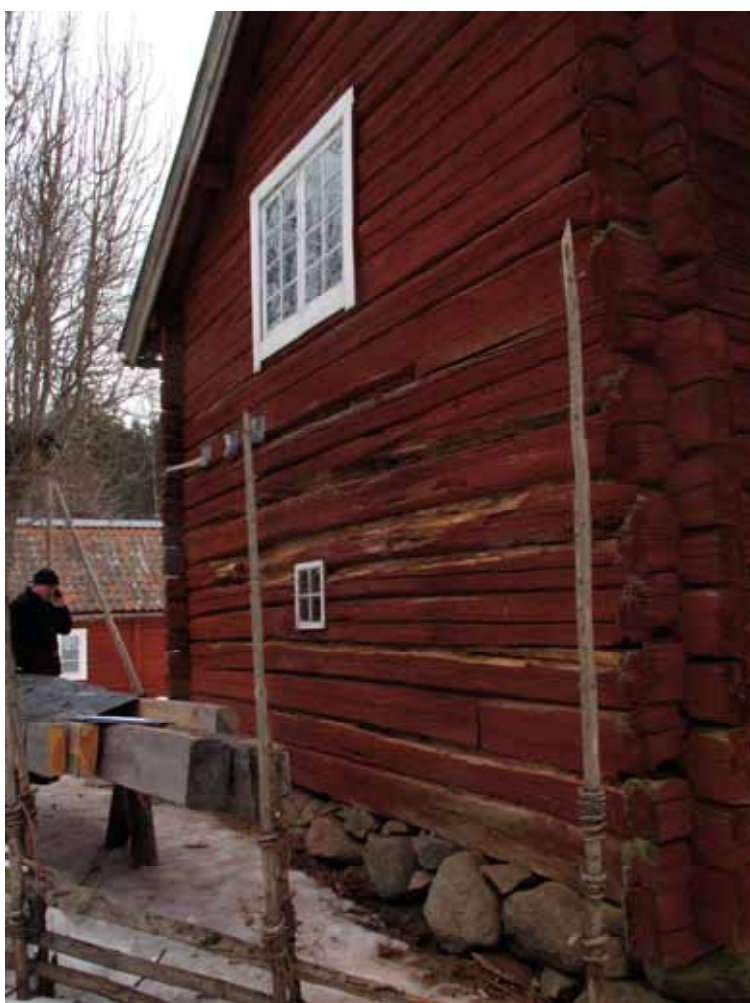
Västfasaden efter rensning av rötskador. Lp20110374.
