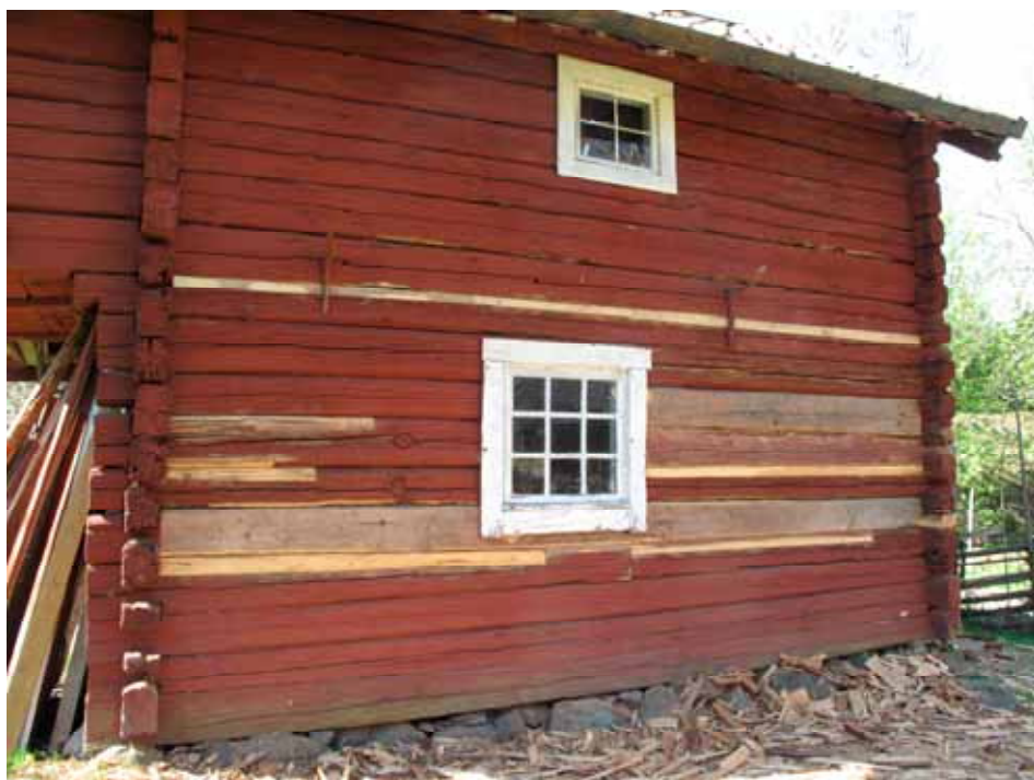
Nordfasaden efter lagning. Varv 7 byttes i sin helhet sträckan till höger om fönstret. Övriga lagningar är inte genomgående. Lp20110373.
