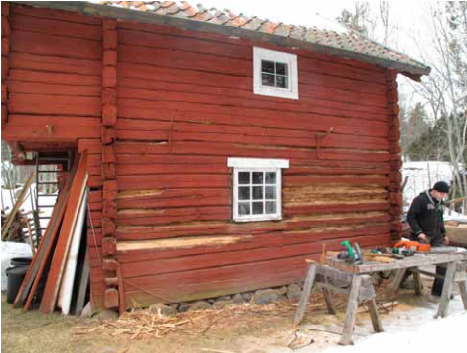
Nordfasaden efter påbörjad rensning av rötskadade ytor. På bilden syns timmerman Ola Lundqvist. Lp20110376.
