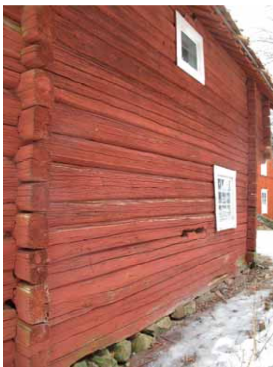
Sydfasaden före lagning. Endast syllen åtgärdades ytligt. Lp20110375.
