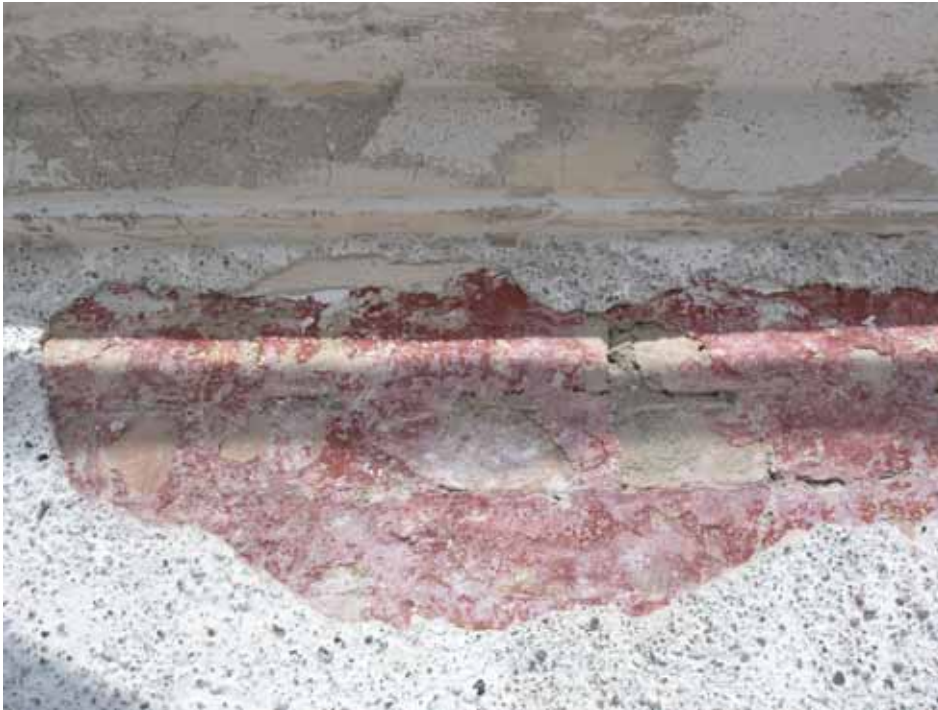
Utmed takfoten på korets sydfasad framkom två äldre putsskikt under spritputsen. Ytterst en slätputs med gul avfärgning bevarad på och utmed takfoten. Underst en tunn, skör slätputs/slamning med kraftig röd avfärgning. Lp20100338.
