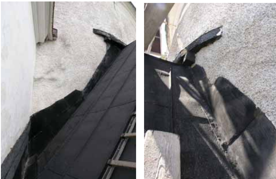
Korets plåtanslutningar till rundhusets fasad i söder respektive nord. Lp20100335 och lp20100323.
