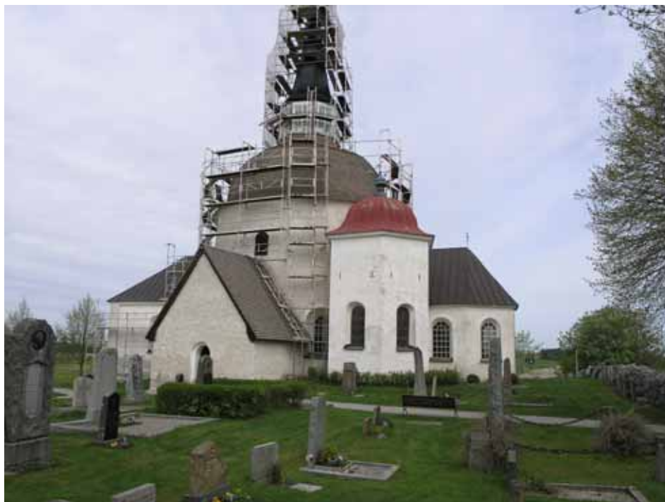
Munsö kyrka från sydöst vid renoveringens inledning. Långhusets tornspira är tjärad. Övriga delar är ännu inte påbörjade. Bild Lp20100314.
