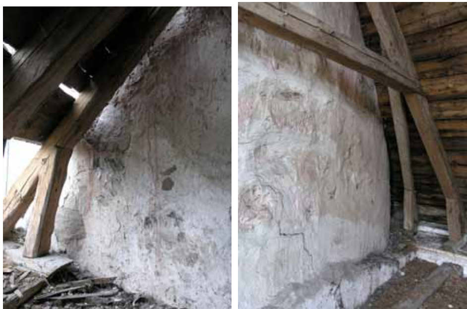
Tv. Norra delen av rundhusets västfasad. På slätputsens finns röda färgspår som har runnit ner från takanslutningen. Troligtvis rödfärg från avfärgning av tidigare spåntak. Th. Södra delen av rundhusets västfasad. Den fläckvisa vita kalkfärgen sitter på en beige kornig slamning som förekommer på delar av gavelytan. Slamningen och kalkfärgen härrör från efter uppförandet av västpartiet. Lp20100328 och lp20100327.
