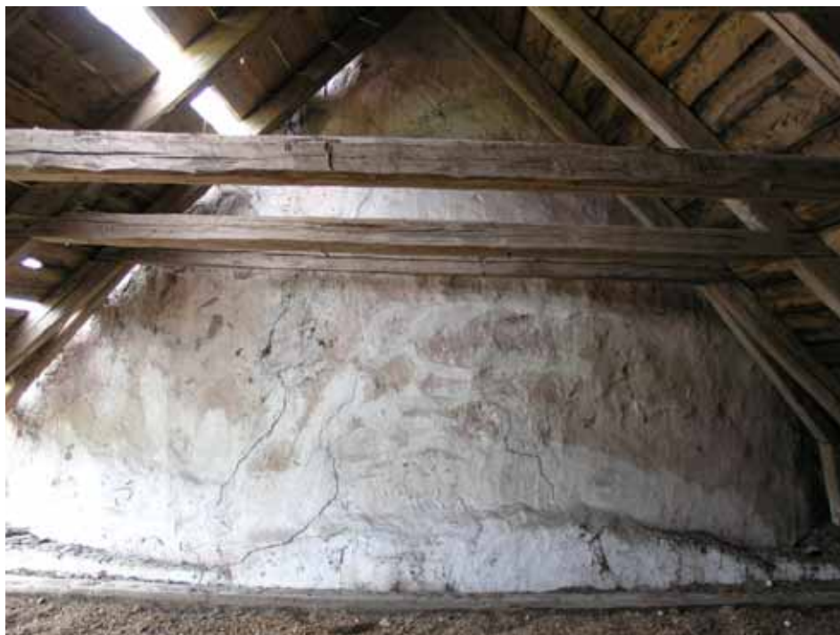
Rundhusets västfasad synlig ovan vinden på västpartiet. Nedtill syns utskjutande murparti kopplat till tillbyggnadens sköldbåge. Den vita kalkfärgen som gör ytan spräcklig är troligtvis tillkommen i samband med lagningar utförda först efter uppförandet av västpartiet. Lp20100330.
