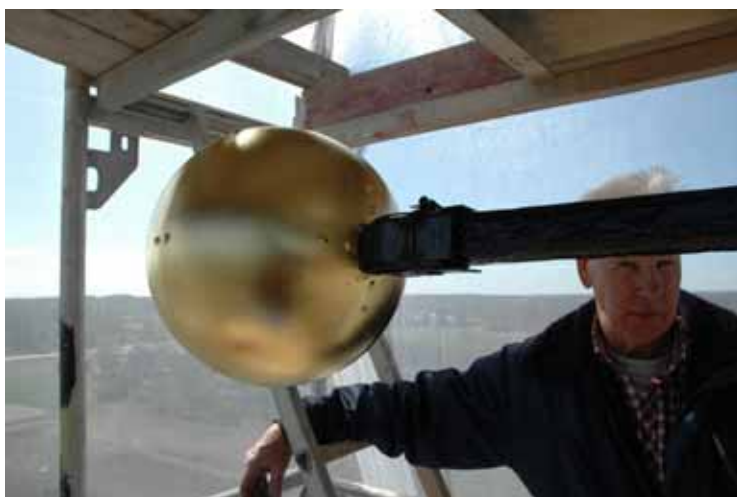
Lanterninens toppdekor med nyföryllda klot, inspekteras av ansvarig entreprenör Joel Berg på Höjdmontage AB. Lp20100298.
