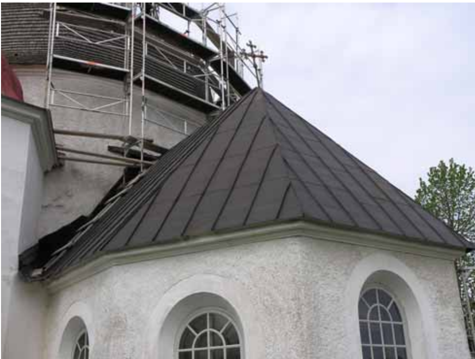
Koret före takomläggning. Lagg märke till ståndskivornas nedtrappning mot gravkoret till vänster i bild. Lp 20100319.
