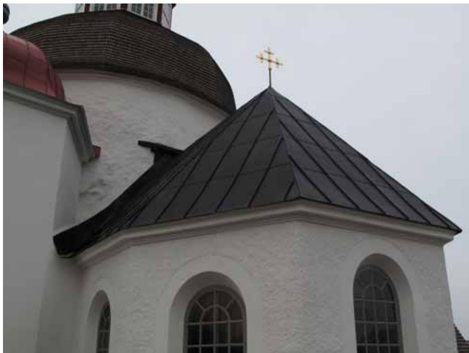
Koret efter restaurering med nylagt plåttak och avfärgade fasader. Ståndskivan utfördes nu utan avtrappning. Lp20100345.
