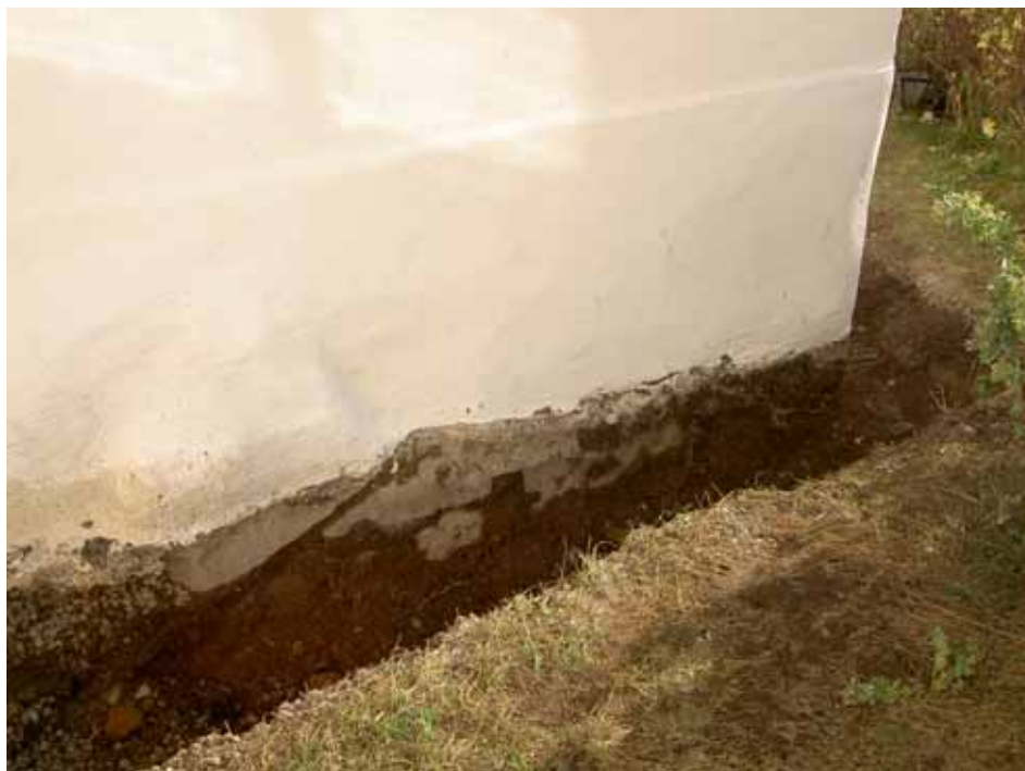
Gravkorets övre grundmur låg i liv med fasaden, åtminstone ner till schaktets botten, på ett djup av 40 cm. Lp20100344.
