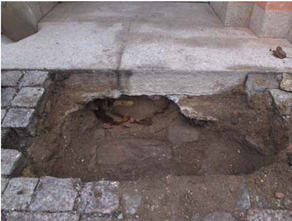
Nedanför trappstenen syns det gjutna fundamentet med utanpåliggande form av träfiber skivor. Stenarna i schaktet var lösa och utan struktur. De avlägsnades i samband med kärnbörningen i betongen. Lp20100457
