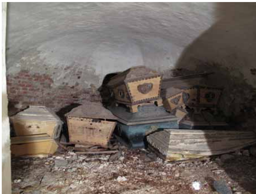
Gravrummet från väster. Golvytan är täckt av nedfallet putsbruk, grus och skelettdelar. Putsbortfallet är främst knutet till väggarnas nedre delar. Lp20100449
