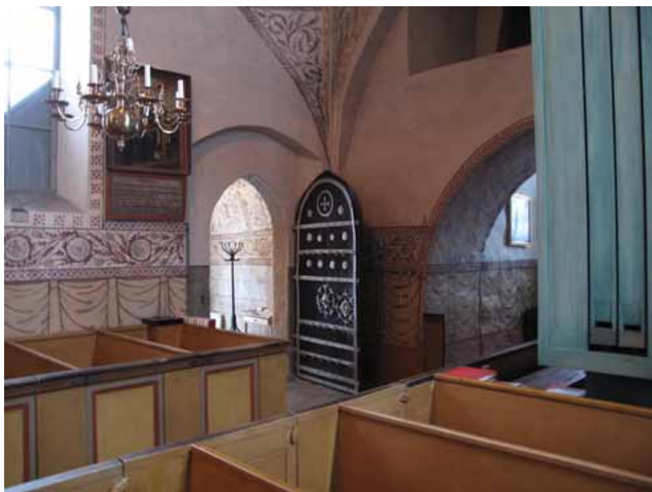
Vy över kyrkrummets sydvästra del före läktarbyggnationen. Epitafiet över Bängt Tyneson syns till vänster om porten ut mot vapenhuset. Målningen hänger nu i koret. Lp20100542.
