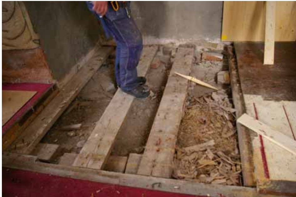
Trägolvet i nordvästra hörnet avlägsnades och sänktes lokalt under den nya läktaren för att ansluta till mittgångens något lägre golvnivå. Lp20100553.
