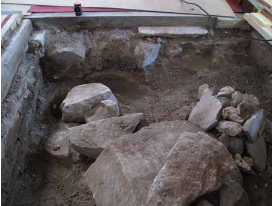
Golvytan från norr. I profilen mot mittgången syns den äldre golvnivån av kalksten under den nuvarande cementgjutningen. Kalkstensplattorna är grundlagda på natursten. Ytan i övrigt hade inte kalkstengolvet bevarat. Lp20100549.
