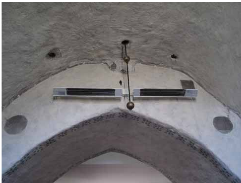
Ringkammaren före åtgärd av putsskador till följd av äldre ledningsdragningar. Utbyte av den något malplacerade infravärmen sköts på framtiden. Lp20100551.
