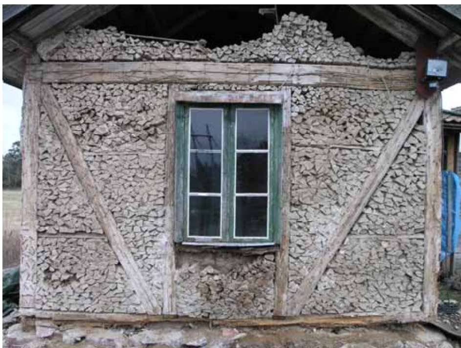
Närbild av södra gavelfasaden före reparation. Väggen är konstruerad som ett fackverk med en timmerstomme och fyllningar murade med kubb och lerbruk. Lägg märke till tryckfördelande mellanlägg i form av horisontellt lagda brädor. Bildnr lp20100043.
