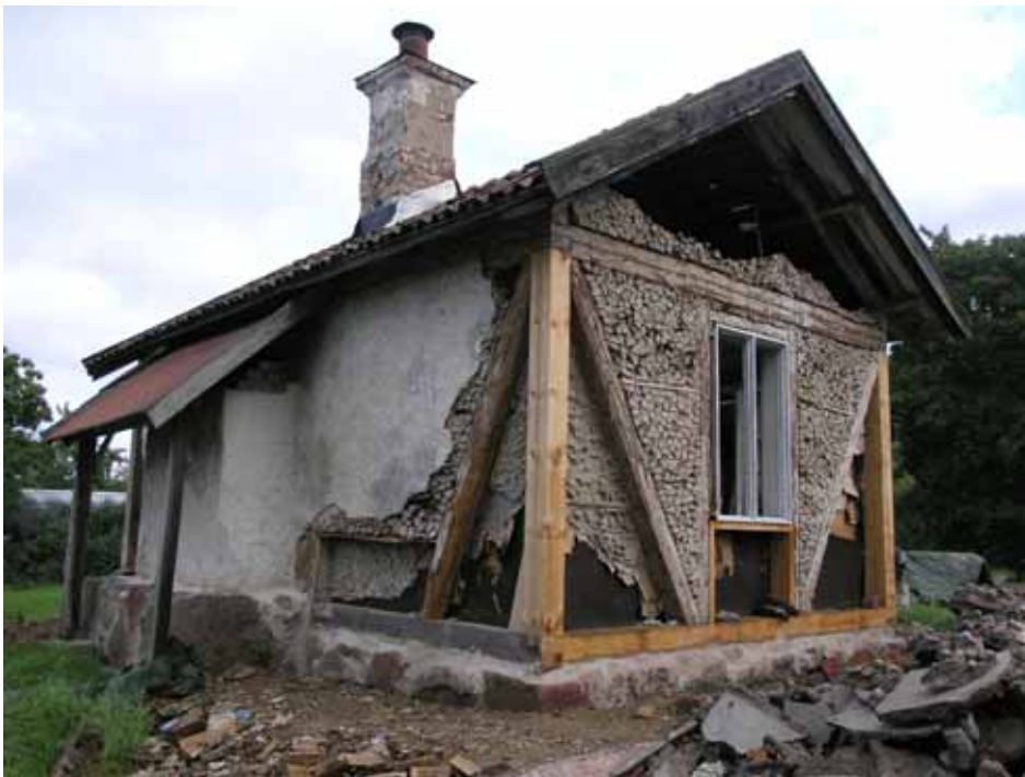
Vy från sydöst med en lagad timmerstomme. Tömnda fack murades om. Bildnr lp20100028.
