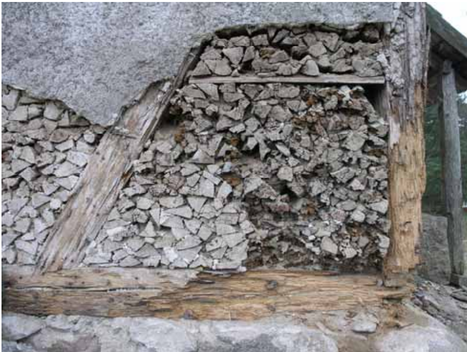
Syllhörn i nordväst före reparation. Syll, hörnstolpe och de nedre fackverken byttes ut. Notera det påtagligt skadade kubbverket till höger i bild. Bildnr lp20100024.
