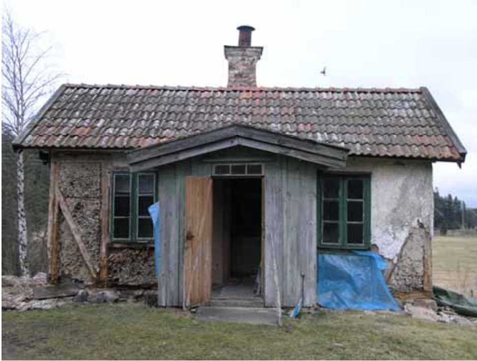
Gårdssidan med farstukvist före reparation. Rötskadade fasadpartier har redan blivit delvis frilagda från pust. Bildnr lp20100054.
