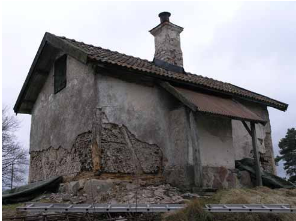
Vy från nordväst före reparation. Syll och stolpar hade omfattande rötskador nedtill. Skorstenens tegelmurverk hade ytliga skador, merparten av putsen var bortfallen. Bildnr lp20100021.
