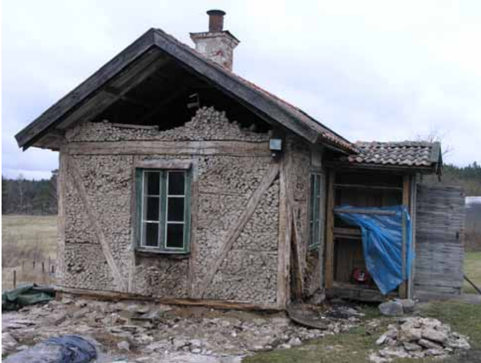
Södra gavelfasaden efter friläggning från puts, men före reparation. Gavelröset var raserat och det centralt placerade fönstret hade fallit in på vinden. Bildnr lp20100019.
