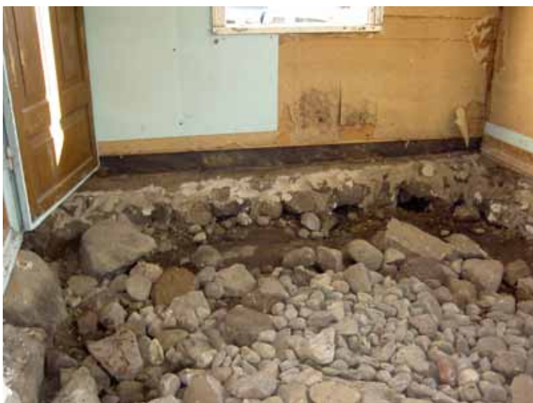
Kammarens golv efter borttagande av betonggolv och upprensning av underliggande löst material. Vy från väster. Bildnr lp20100049.
