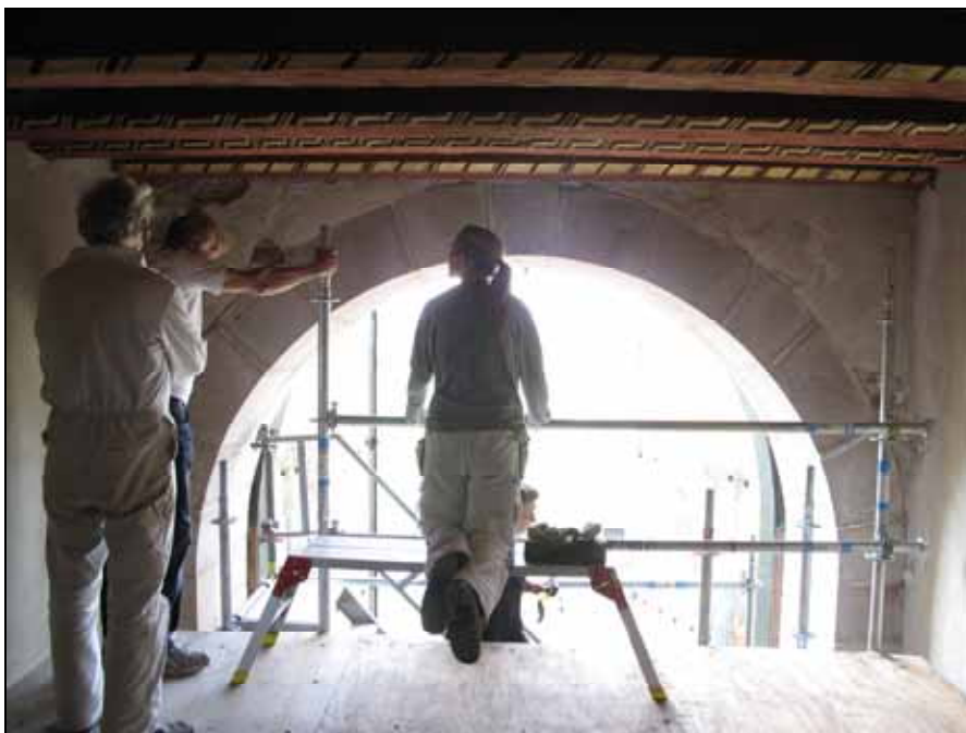
Putsen var skadad i svicklarna mot portalen i väst. På Bilden Thomas Wängelin och Theresia Strömgren, Wängelin konservator samt Ingemar Sundsberg, Sundberg Byggadministration och projektledning.
