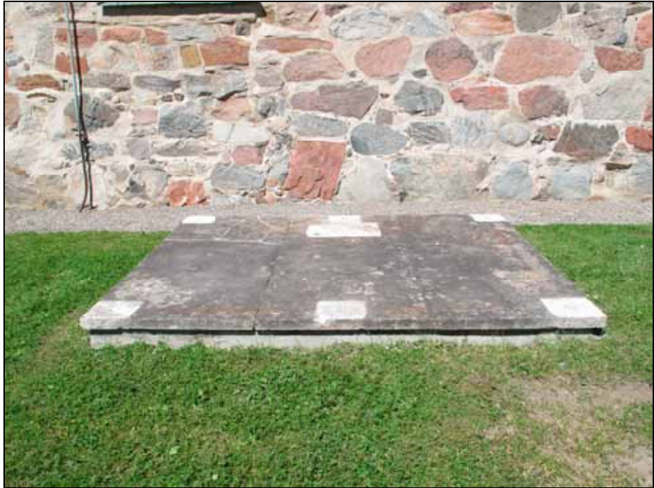
Stenhällens sprickor och trasiga stenar limmades.
