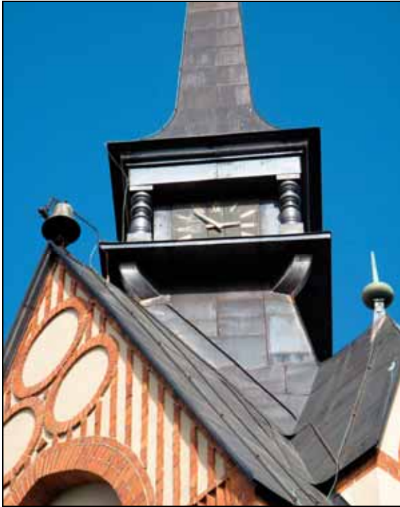
Efter renovering av tornets tak och spirans nedre del med urtavlor, balustrar och i väster en kyrkklocka fäst på tornets taknock. Bildnr: lp20100472
