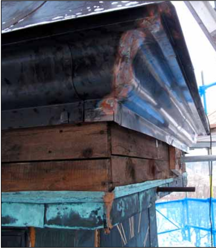
Profilerad list med ny kopparbeslagning. Äldre ventilationsrör av järn på alla fyra sidor ovanför klockan. I dag finns bara ett rör kvar, resten är tomma hål. Bildnr: lp20100150
