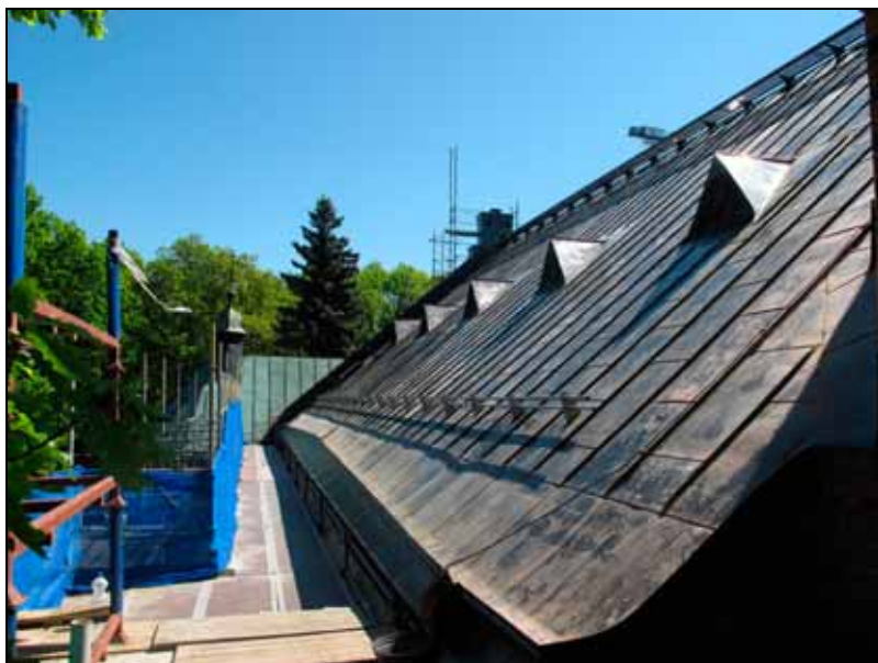
Långhusets norrsida efter omläggning. Gångbrygga samt stosar för luftning av vindsutrymme är placerade vidnock mot norr. Befintligt skyddsräcke målas i brunt för att stämma överens med kopparplåten. Bildnr: lp20100164
