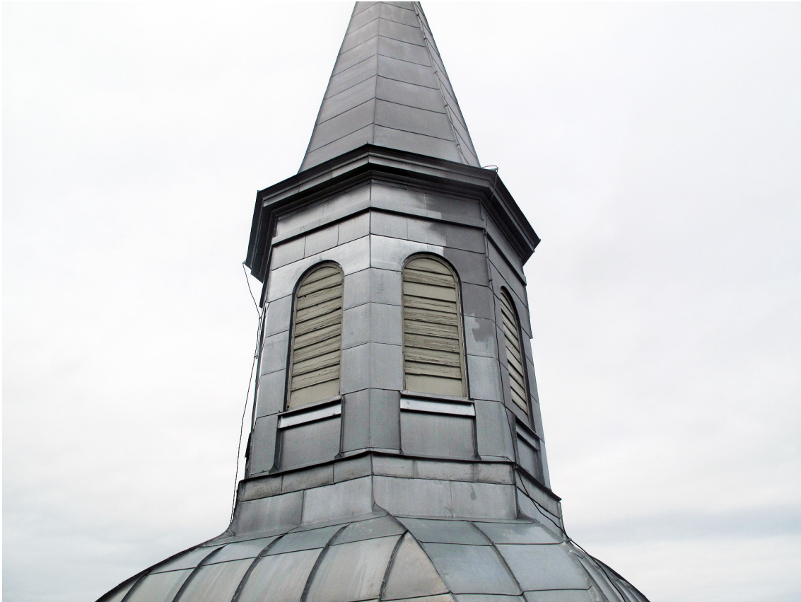
Fig 1. Grundmålning med primer i grå kulör påbörjad på torntak. Mörkare partier är målade medan ljusare är obehandlade. Foto Hedvig Bellberg, bildnr LP201200168.
