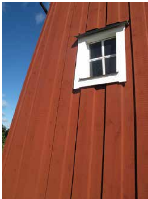
Figur 8. På bilden är allt utom bågarna i fönstret samt det undre blecket renoverat. Foto: Hedvig Bellberg, LP_2012_00611
