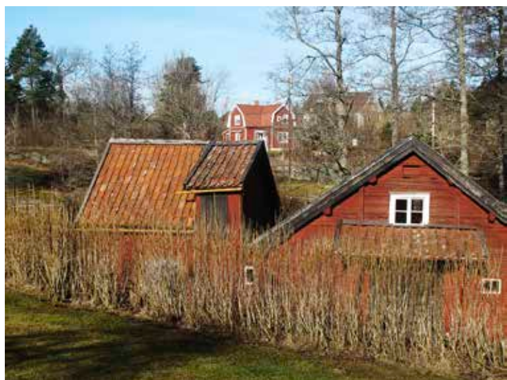
Figur 7. Kvarnkammarens tak innan åtgärd. Lp 201200791.
