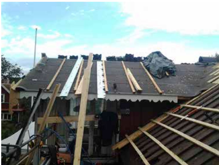
Figur 8. Verandataket med råspont och papp. Bild från entreprenören.
