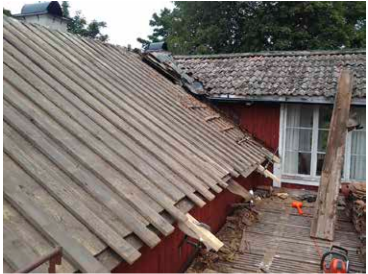
Figur 5. Södra takfallet med borttaget tegel och läkt. Bild från entreprenör.
