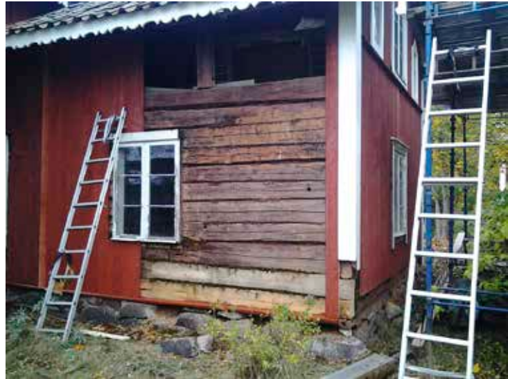
Figur 13. Skadat timmer i sydväggen till höger om verandan. Bild från entreprenören.
