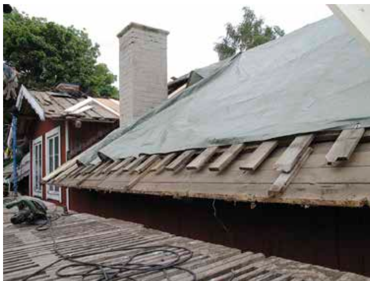
Figur 1. Norra takfallet med borttaget tegel. Foto Albin Uller 2012. Lp201200674.
