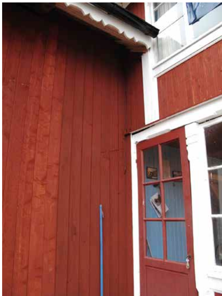
Figur 12. Spår efter det tidigare verandataket. Foto Albin Uller 2012. Lp201200704.
