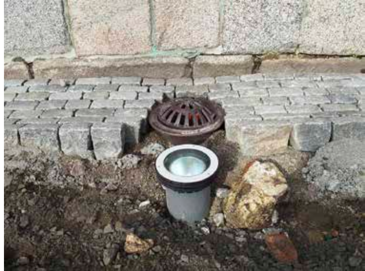
Figur 3. Ny fasadbelysning samt uppsamlingsbrunn. Foto Albin Uller 2012. Lp 201201017.
