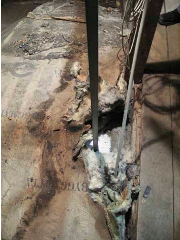
Figur 9. Den nya upphängningen och genomförningen i valvet. Foto Albin Uller 2012. Lp 201200953.
