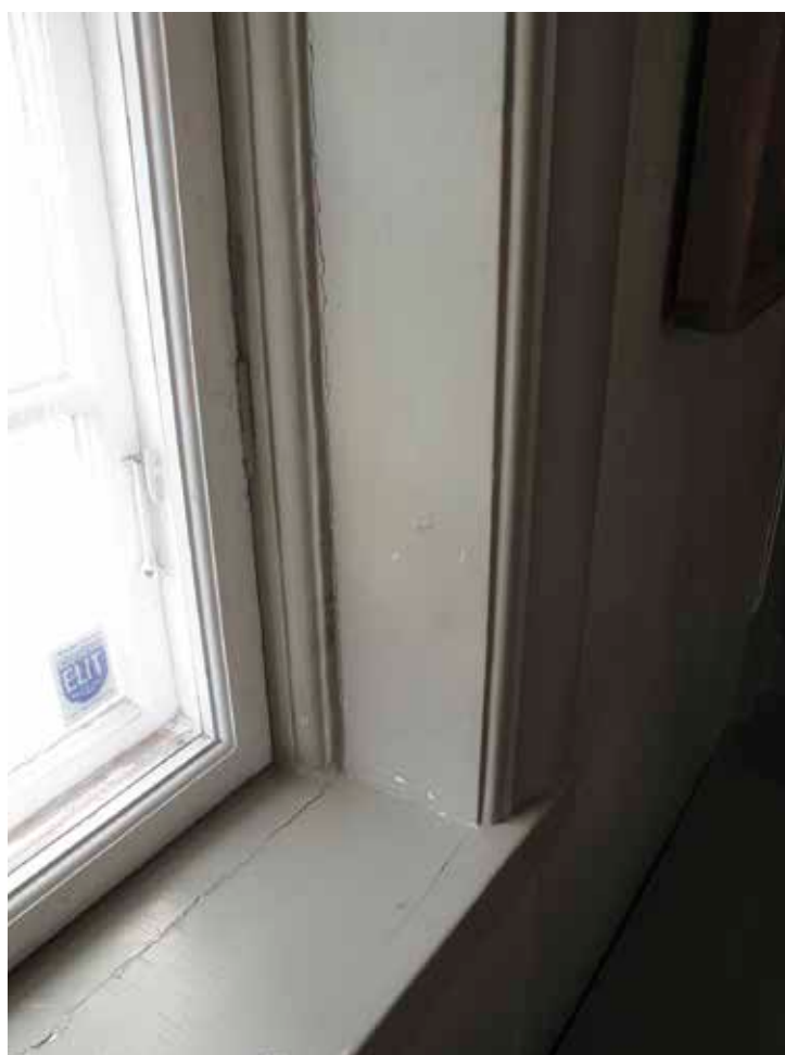
Figur 12. Fönsterfoder innan ommålning. Foto Albin Uller 2012. Lp201200729.
