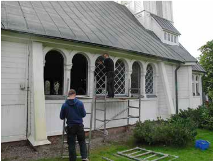
Figur 2. Fönstren mot norr i långhuset, med en blekgrå kulör före restaurering, under urtagning av bågarna. LP_2013_00026. Foto H Bellberg
