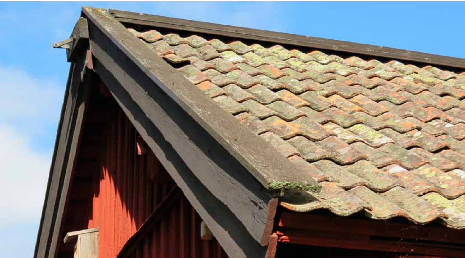
Fig.7 LP_2014_00112. Vindskivor och vattbräda före genomförda arbeten.
