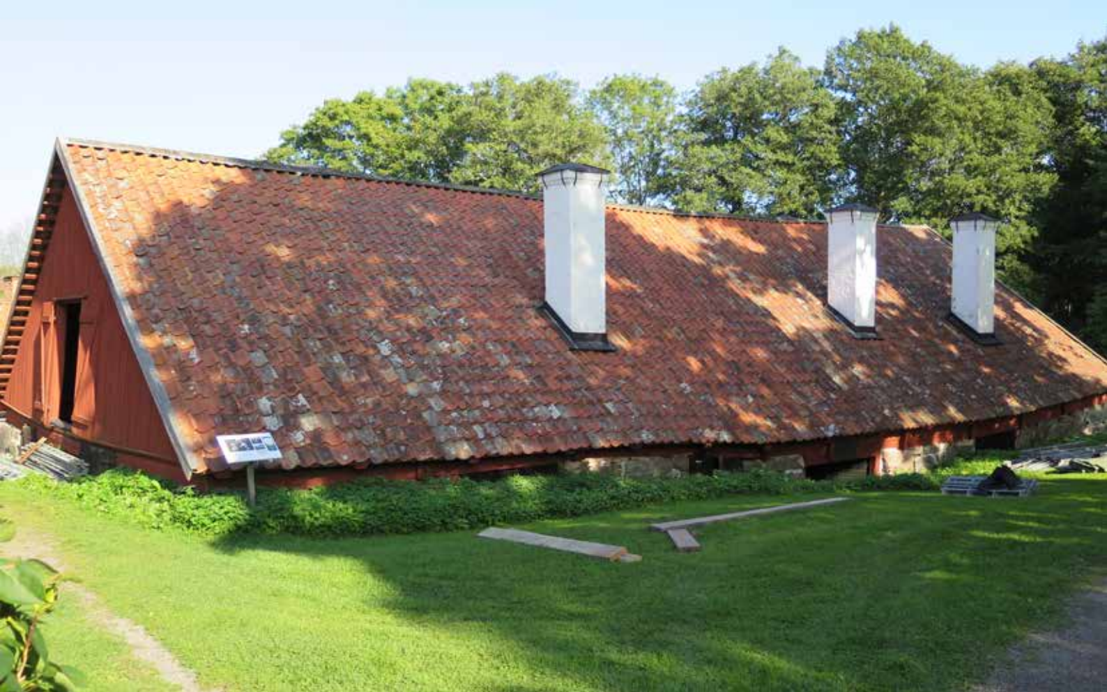
Fig.2. Stora smedjans södra långsida före genomfört arbete. Taket sviktade över entrén. LP_2014_00193.
