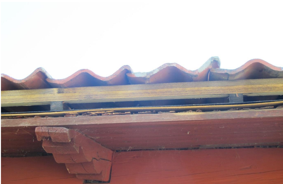
LP_2016_00077. Här syns alla lagren på takfallets långsida i genomskärning efter takomläggningen. En profilskuren taktass, brädorna i takutsprånget, spåntäckningen, masoniten, pappen, ströläkten, bärläkten och takteglet.
