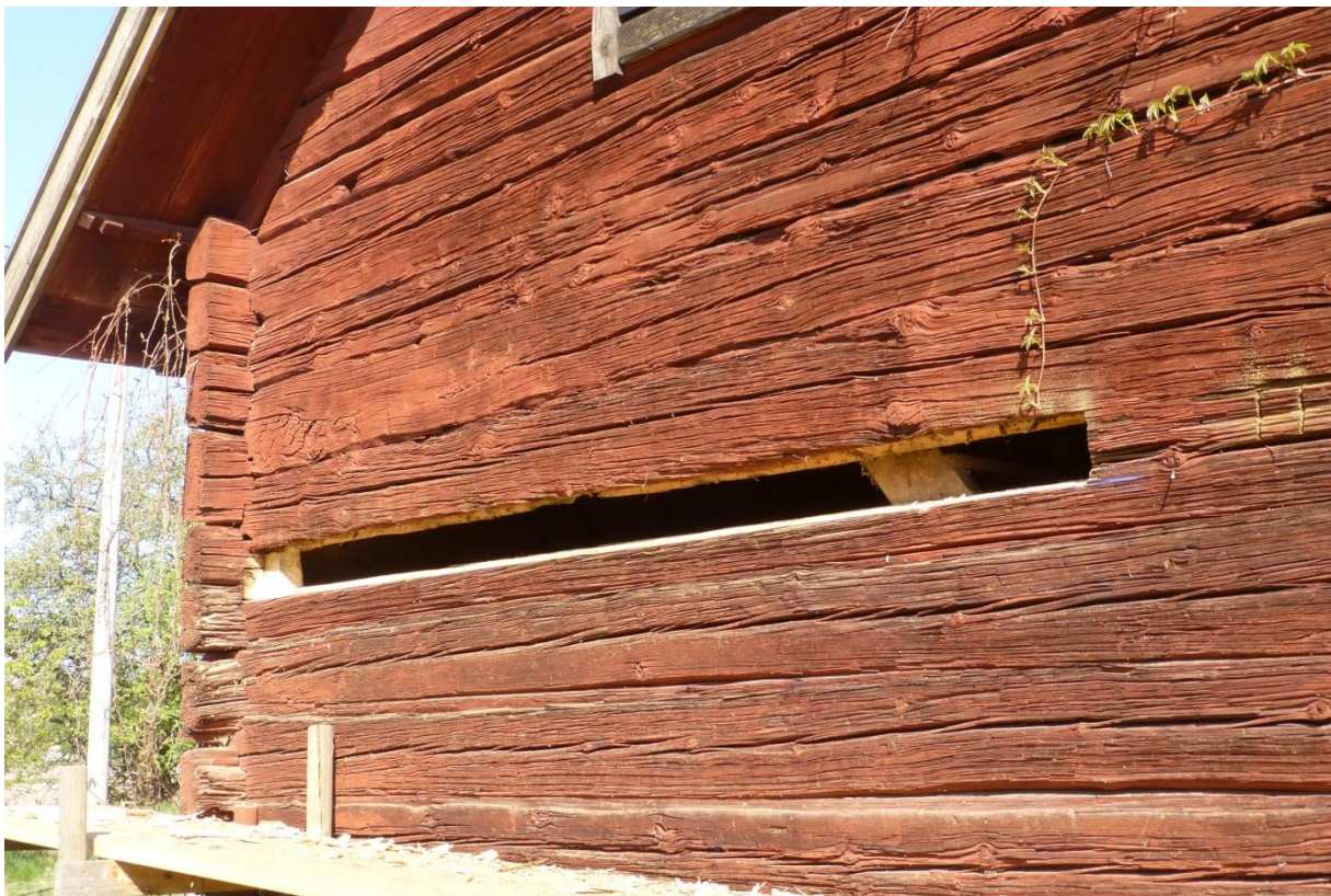
Här har timmermannen tagit ut en stor bit av den gamla rötskadade stocken, delen mot väster. Foto E. Lagerström
