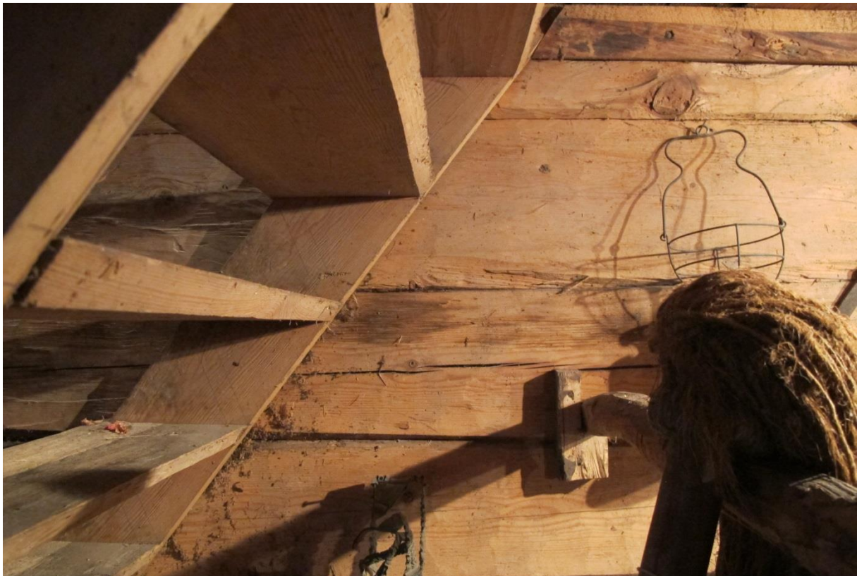
LP_2016_00065. Rötskadan syntes även på insidan av sydväggen.
