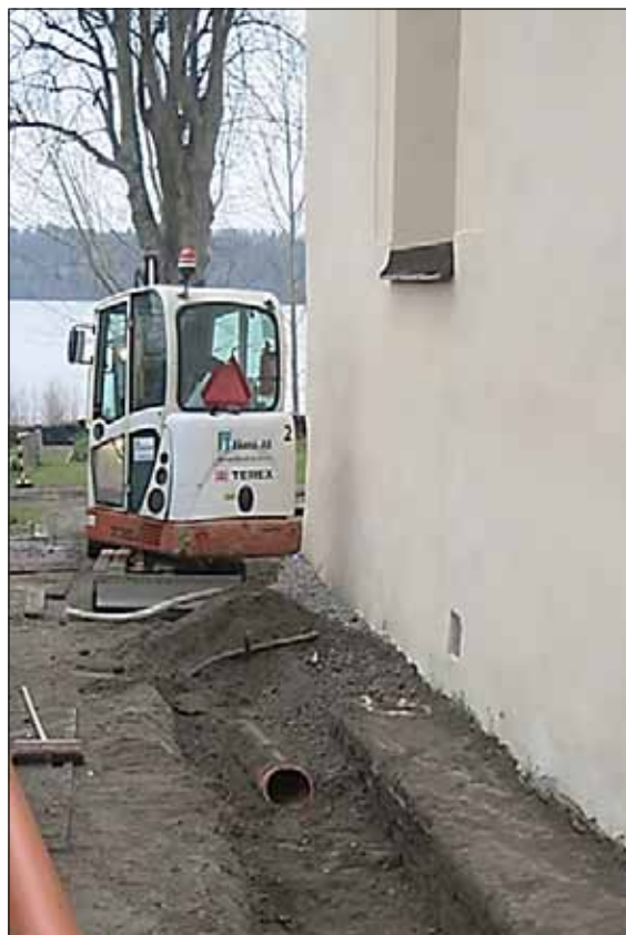
Fig. 10. På bilden till vänster ses en av dagvattenledningens huvudledningar, ett markavloppsrör \varnothing 250 mm som passerar kyrkans östra gavel. Foto: Lars Andersson.
