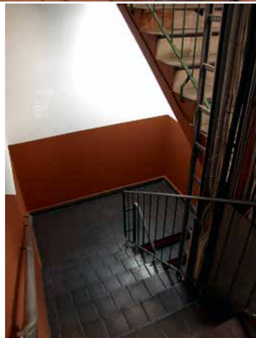
Fig. 28: Serviceutrymme, här i form av ett oförändrat trapphus. LP201600114. Fotograf Albin Uller.
