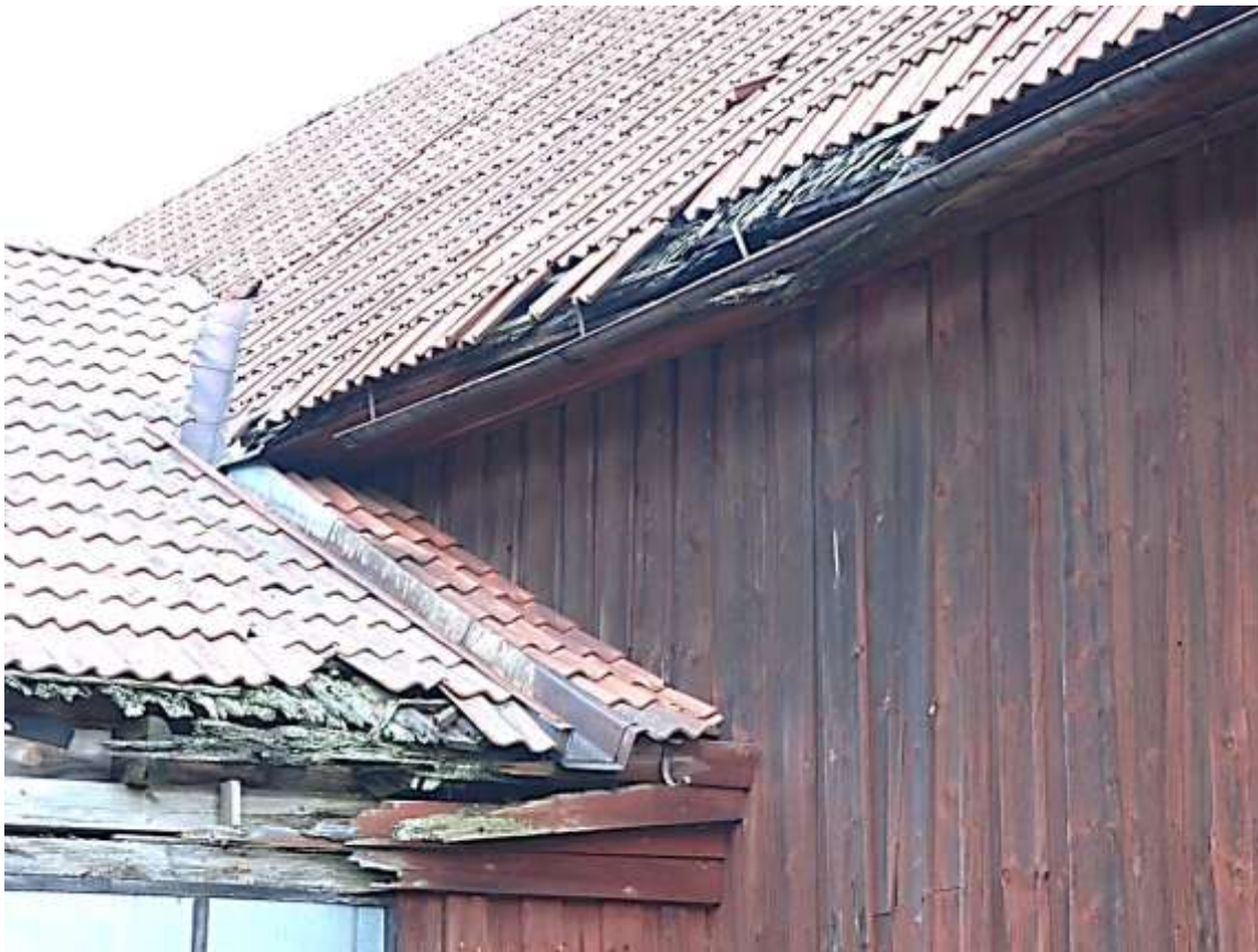
Skador i vinkeln mellan logens västra takfall och den lägre ladugårdsdelens södra takfall. Foto Rolf Hammarskiöld, Stockholms läns museum
