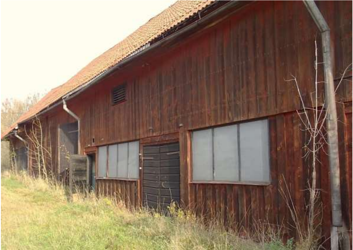
Ladugårdens västra fasad vetter mot Lillsvedsvägen. Pardörren närmast i bild leder in till djurdelen. Den öppnade dörren längre bort leder in till mjölkrummet. Foto Johannes Kruusi, KMV forum
