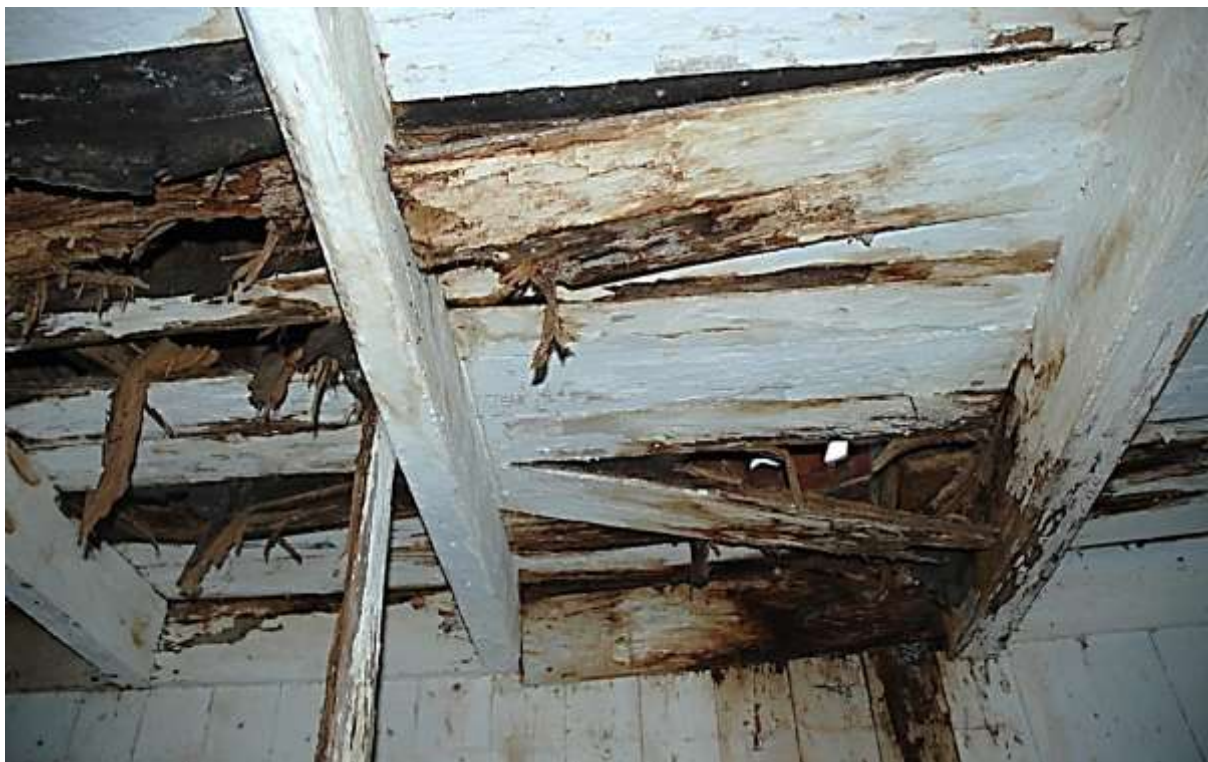
Ladugårdens mellanbjälklag och takpanel är så svårt rötskadade att de börjat ge vika. Foto Rolf Hammarskiöld, Stockholms läns museum
