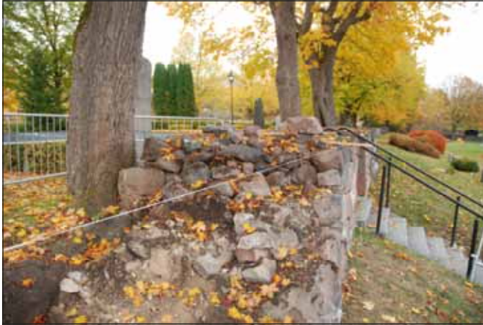
Fig. 3. Sektionsbild av kyrkogårdsmur före omläggning, mot väster 2016-10-19. Foto: Lars Andersson.
