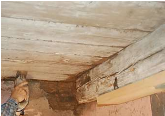
Rötskadad panel och bjälke kapades bort. Fotot togs 2016-07-12.
