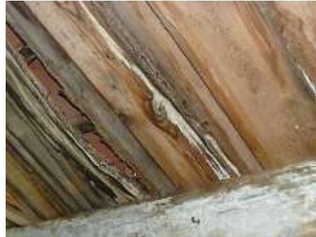
I byggnad 5 har taket rötskadats till följd av långvarigt läckage. Foto 2016-07-06
