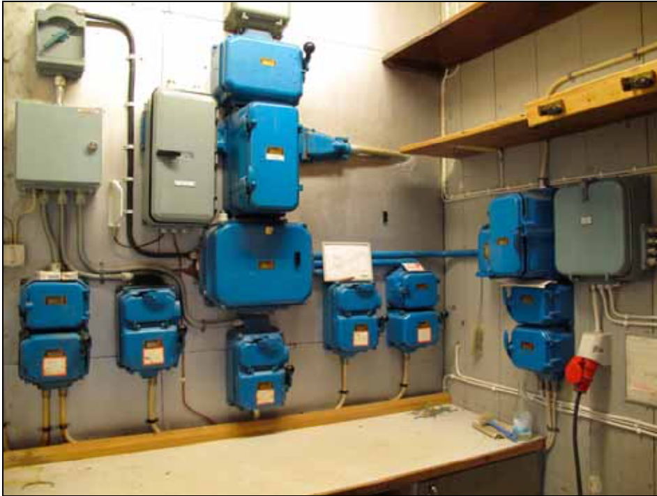
Tornets bottenvåning med kombinerat el och vaktmästeri före renovering. Foto: Cecilia Pantzar.
