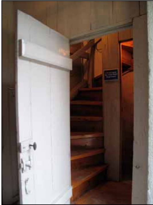
Dörr till läktare i tornets bottenvåning före renovering. Foto: Cecilia Pantzar.
