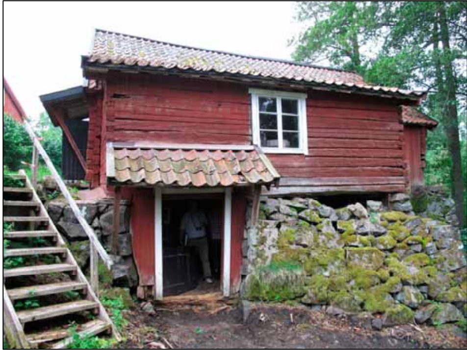
Det gamla skärmtaket med dess anslutning till fönstret samt den bortruttade tröskeln och vänstra stolpen. I bild syns föreningens ordförande Rune Underskog. Lp20111001.
