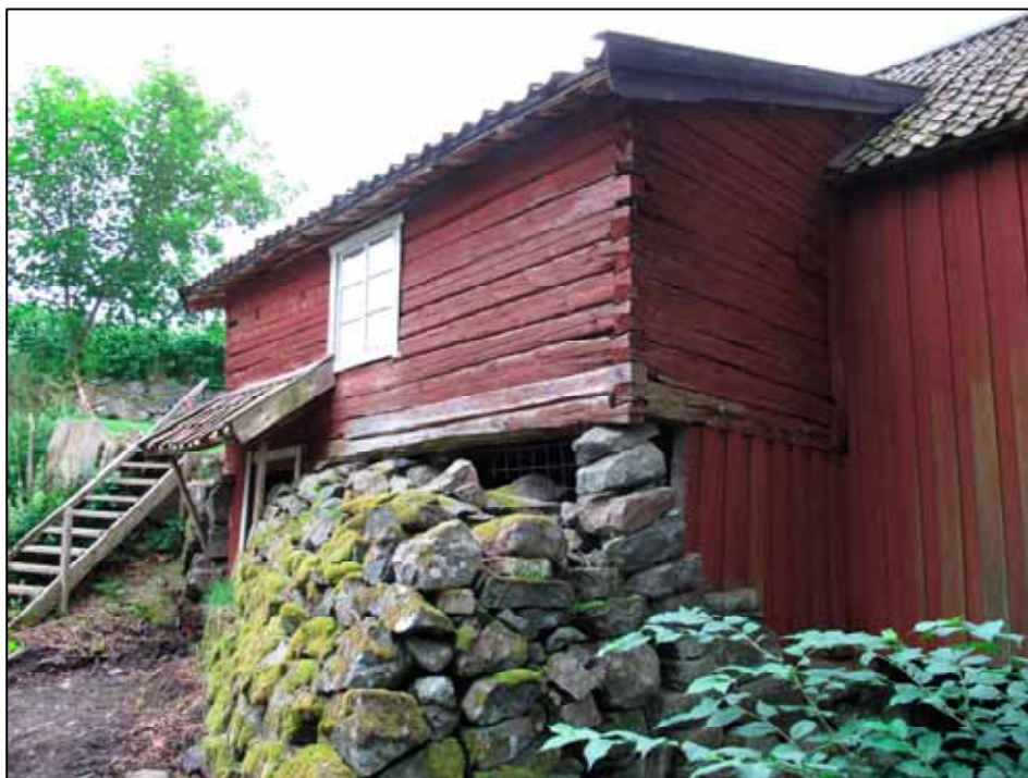
Kvarnens norra hörn med rasad grundmur. Lp20111000.
