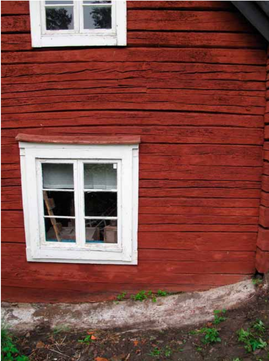
Sydvästra gaveln före lagning. Här syns även betongrännans anslutning till byggnaden. Lp20111002.
