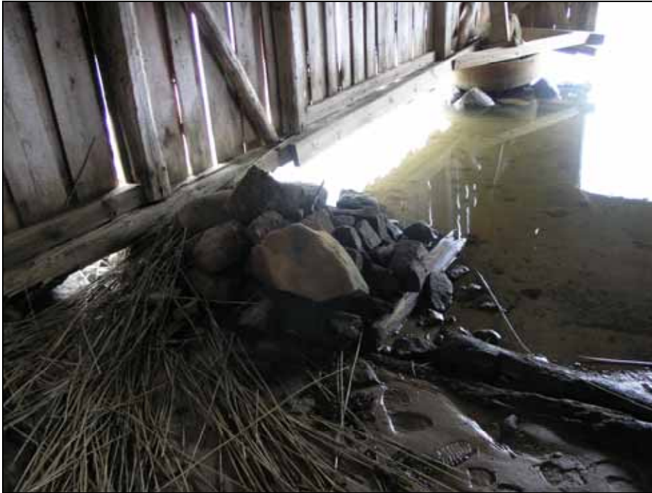
Båthuset före renovering med cementrumma och urfallen stenkista. Foto: Niss Maria Legars, Stockholms läns museum, bildnr: lp20100134
