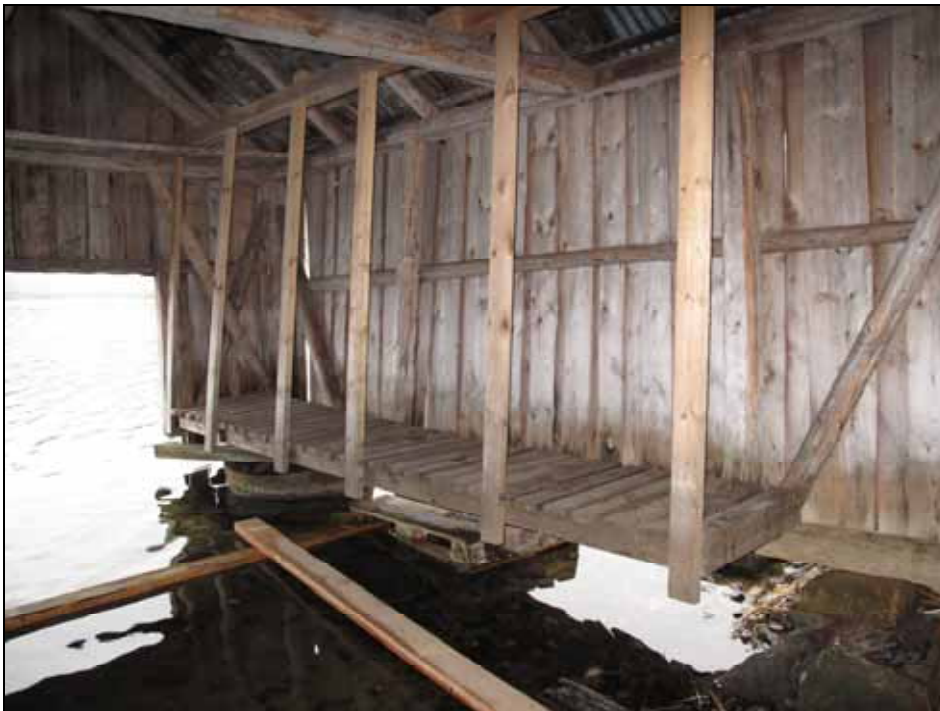
Båthuset före renovering. Foto: Niss Maria Legars, Stockholms läns museum, bildnr: lp20100135.
