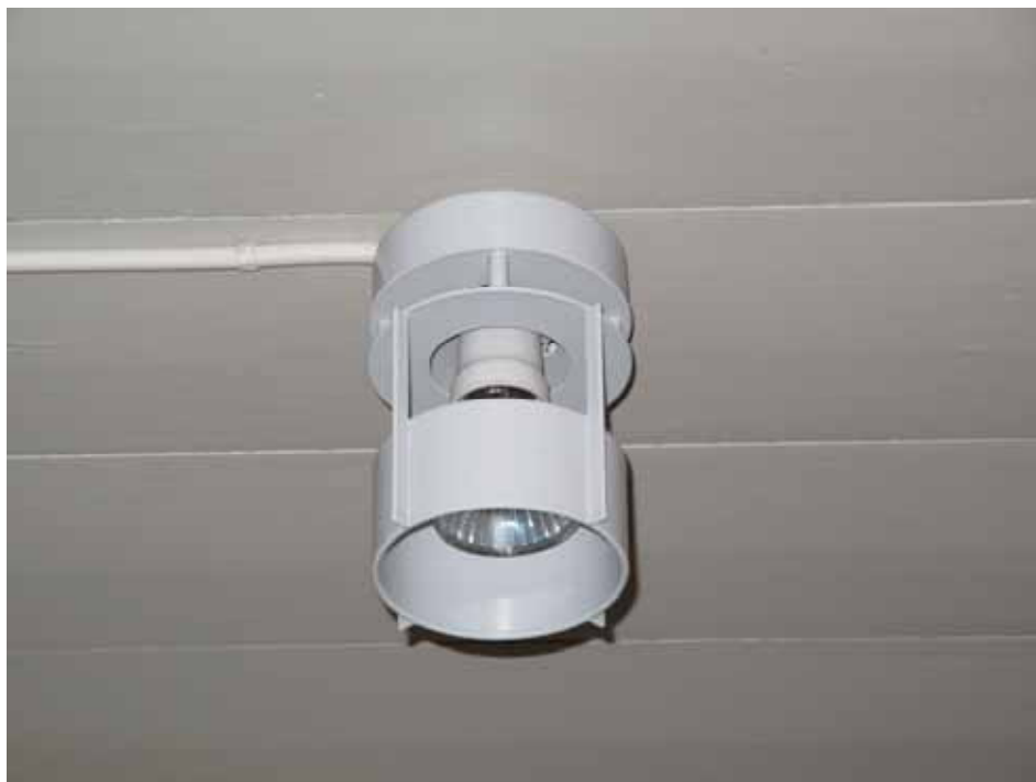
Ny armatur som bland annat återfinns under läktaren. Lp20110191.
