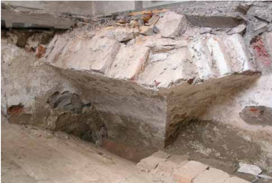
Sydvästra hörnets bevarade kryssvalvsanfang. Tunnvalvet ansluter mot sydväggen med stötfog och mot västväggen med ett sekundärt uppmurat stöd. Lp20110210.
