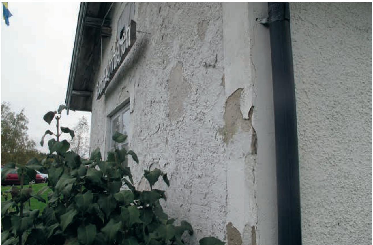
LP 201300558. Skadebilden på stugorna före restaureringen, foto H. Bellberg 2012
