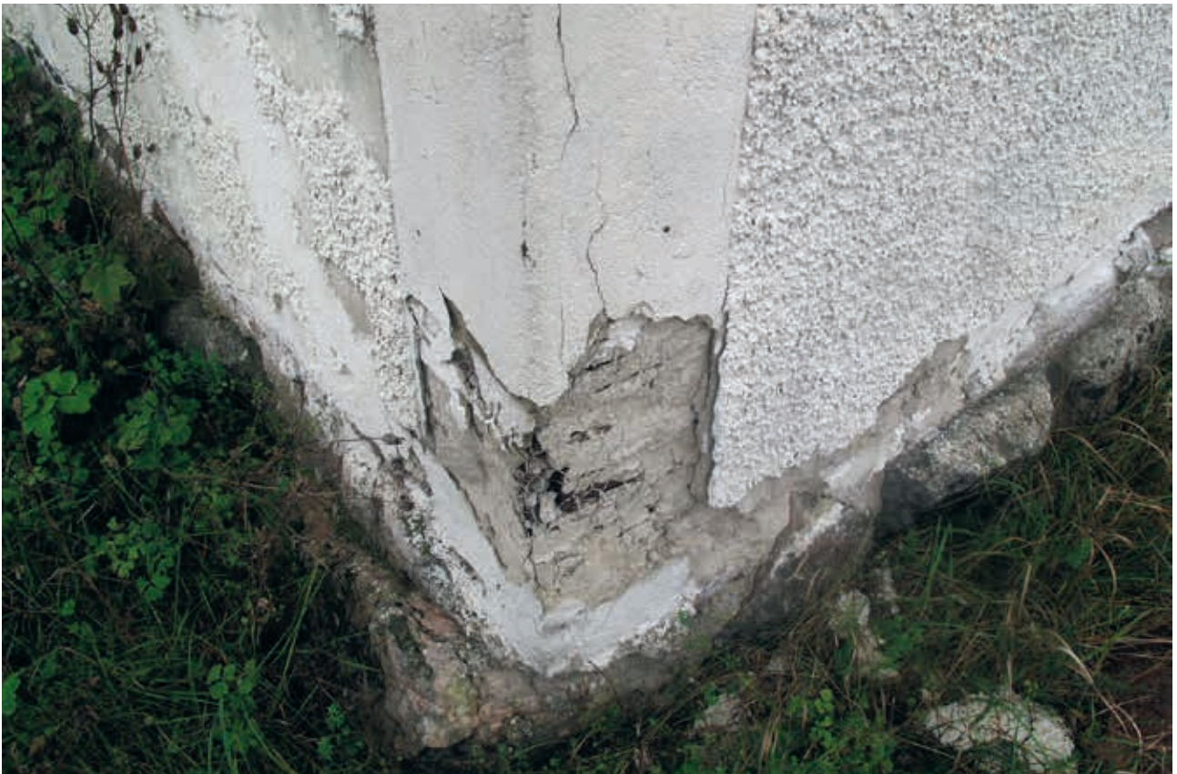
LP 201300553. Skadebilden på stugorna före restaureringen, foto H. Bellberg 2012
