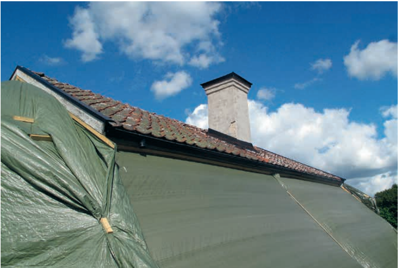
LP 201300567. Skorstenen på den västra stugan med skadad puts längst ner, foto H. Bellberg 2013
