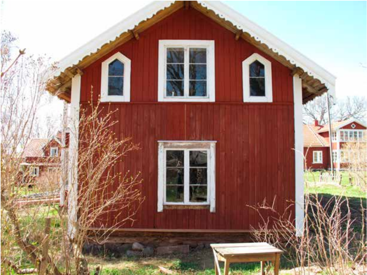
Fig 1. Östra gaveln innan renoveringen. Under vattbrädan är den rötskadade syllen blottlagd. Foto Albin Uller 2012. Lp201300499.
