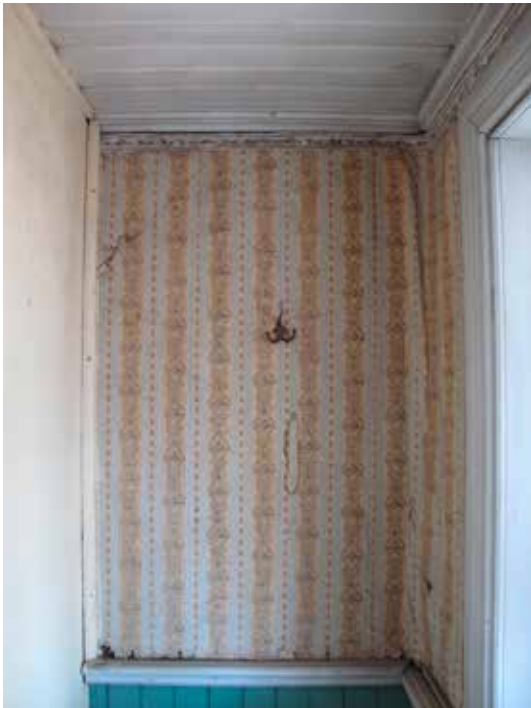
Fig.14. Trapploppet med fuktskadad tapet och masonitskivor. Foto Albin Uller 2013. Lp201300489.
