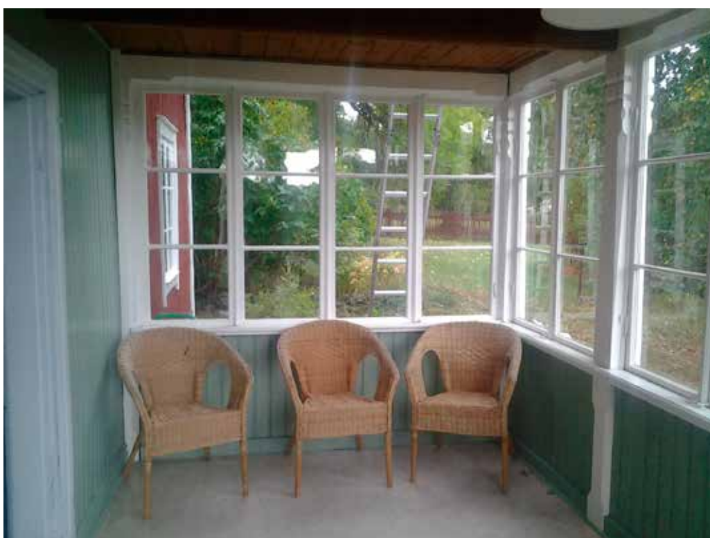
Fig.23. Verandan efter ommålning. Bild från entreprenör. Bild 4.
