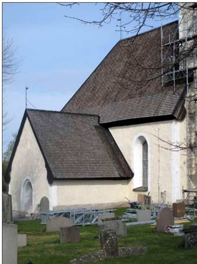
Fig 3. Husby-Ärtinghundra kyrka under renovering. Långhusets södra takfall samt vapenhus. Vapenhusets rännalsplåt var rostig och överdimensionerad varvid den ersattes av en ny mindre plåt.
