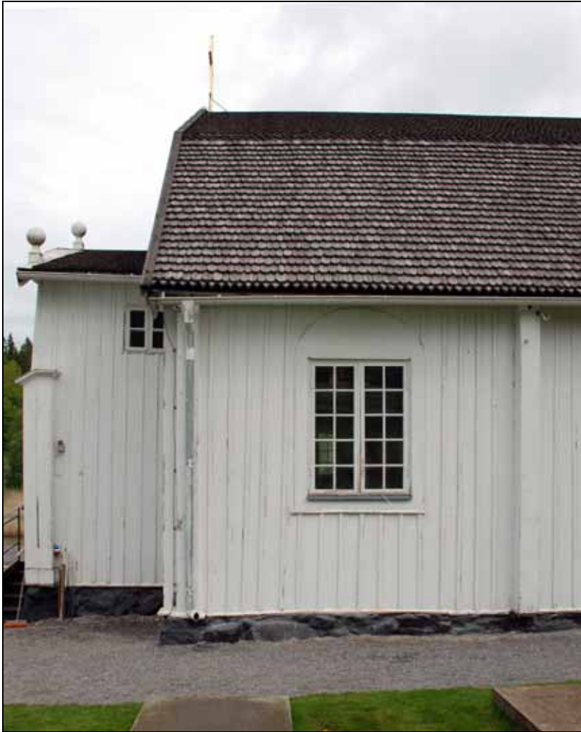
Sydsidan av vapenhuset och del av långhuset före renovering. Spåntäckningen är i stort behov av tjärstrykning. Under hängrännan sitter ett äldre fäste i form av en krok till en tidigare ränna. Bildnr: lp20100178, 2009
